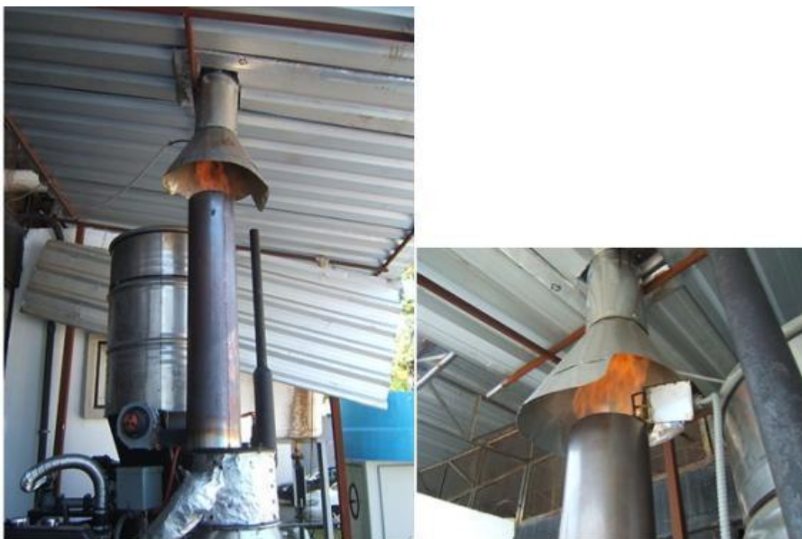
Figura 5-13: Chama decorrente da queima dos gases gerados no gaseificador.
