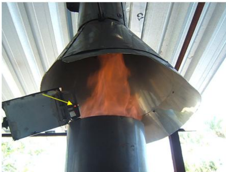
Figura 5-12: Início de chama decorrente do processo de combustão do singás a qual se inicia pela presença do filamento incandescente do ignitor (indicação da seta).
