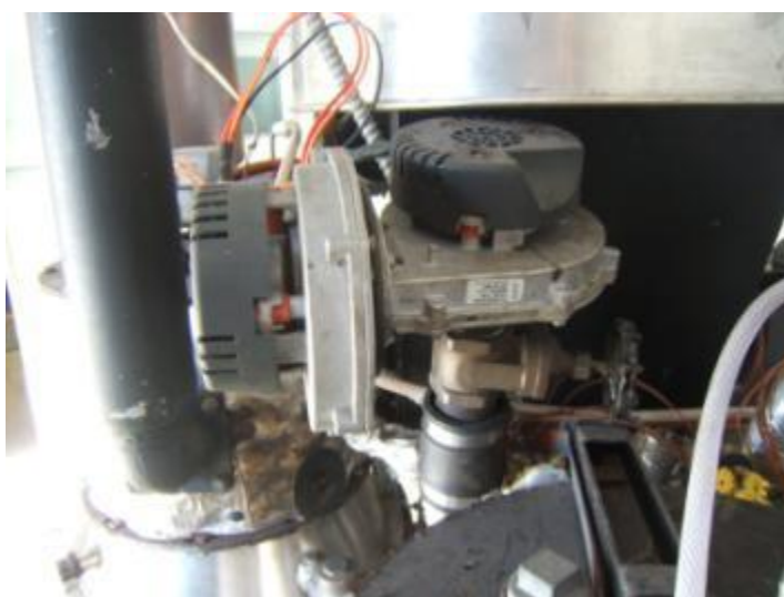
Figura 5-10: Exaustores responsáveis por manter a vazão de ar através do reator.
