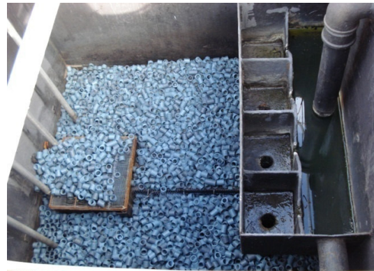
Figura 5: Meio suporte do filtro biológico
