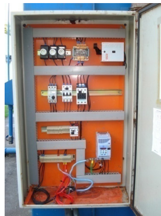
Figura 3: Quadro do conjunto bomba – inversor.
