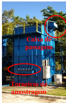
Figura 2: Reator UASB e caixa de passagem
