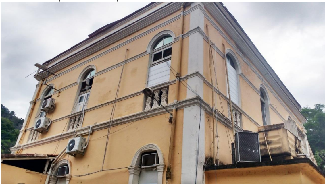
Figura 90 - Detalhe do segundo pavimento da fachada de posterior e lateral esquerda da Prefeitura Municipal de Santa Leopoldina
