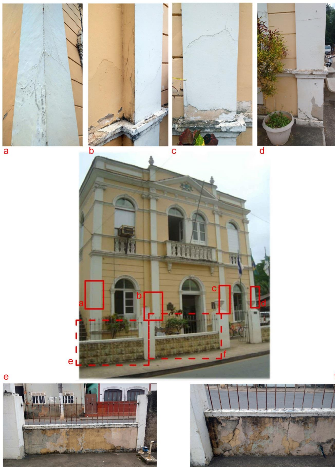
Figura 91 - Fissuras no edifício da Prefeitura Municipal de Santa Leopoldina
