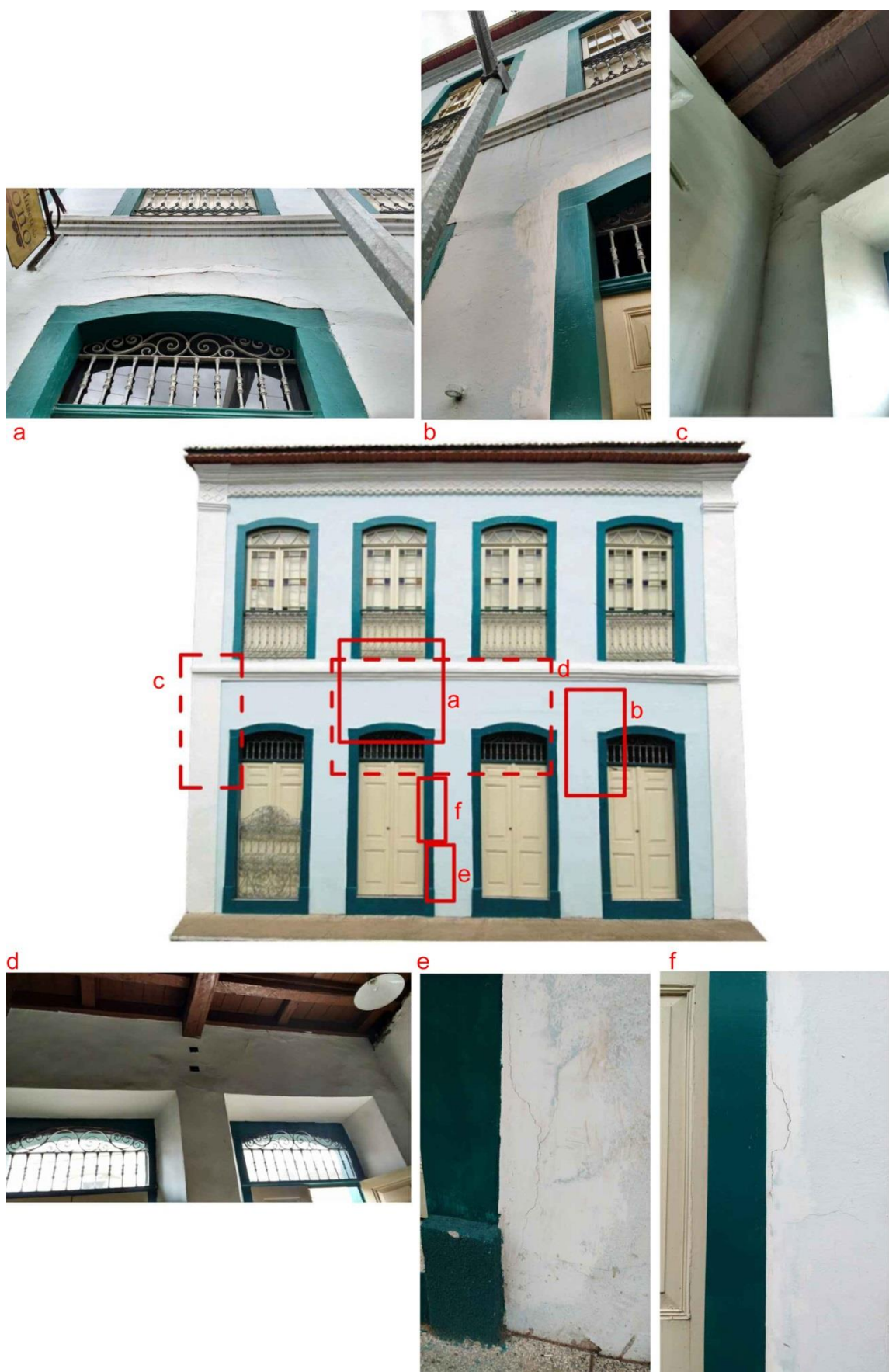
Figura 81 - Fissuras no Museu do Colono
