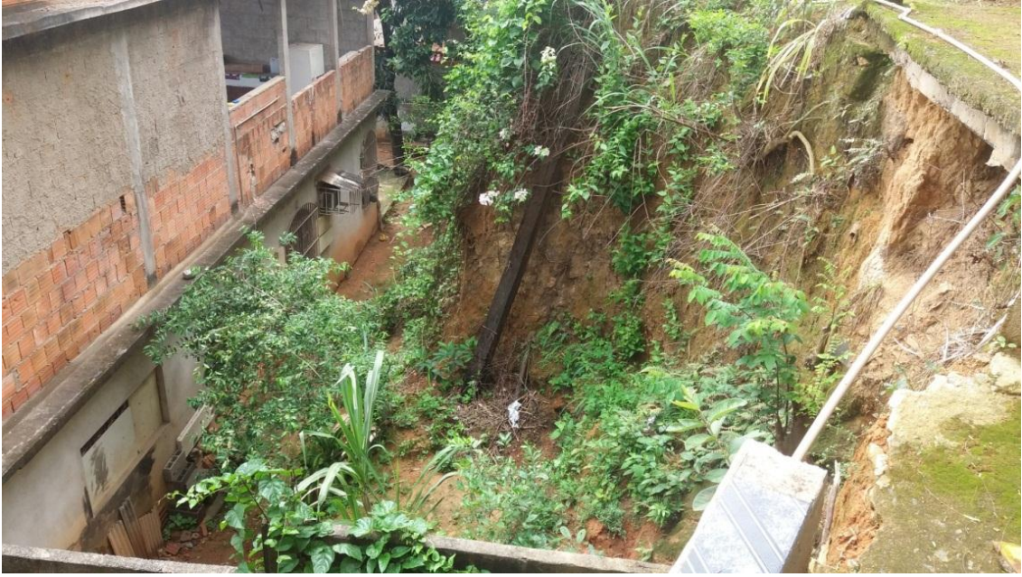
Figura 31 - Casa em situação de risco em Porto de Santana. Foto: Marcela Moraes/Abril – 2016.
