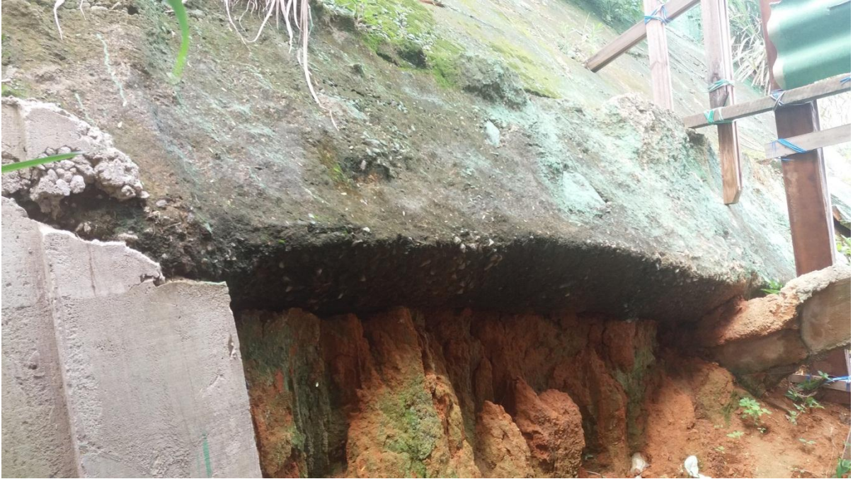
Figura 33 - Muro que desabou em Porto de Santana. Foto: Marcela Moraes/ Abril – 2016.
