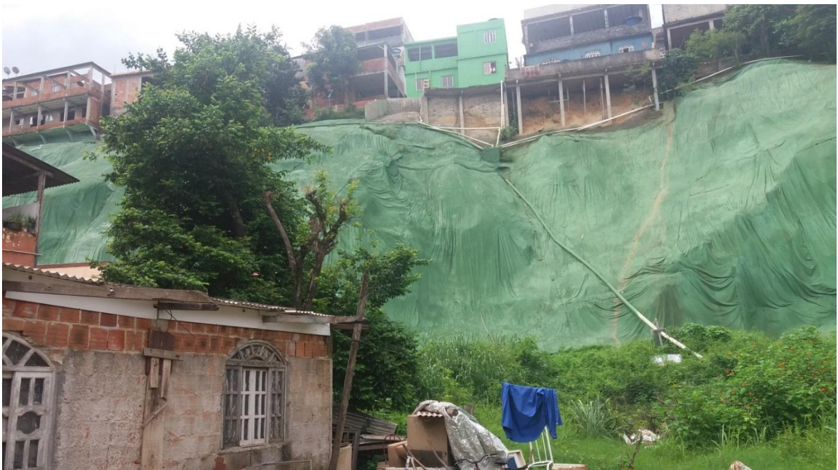
Figura 3 - Sistema de Drenagem em Encostas – Porto de Santana, Cariacica – ES. Fonte: Marcela Moraes /Abril – 2016.
