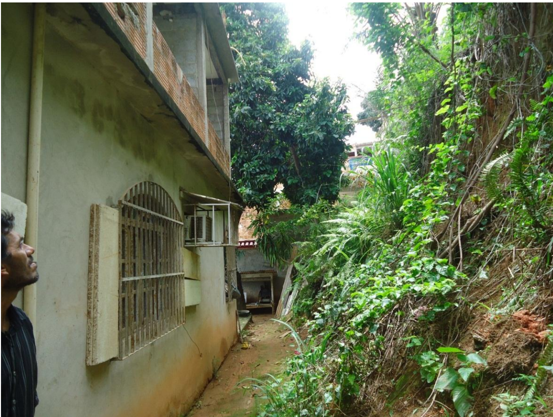
Figura 32 - Casa em situação de risco em Porto de Santana. Foto: Marcela Moraes/Abril – 2016.
