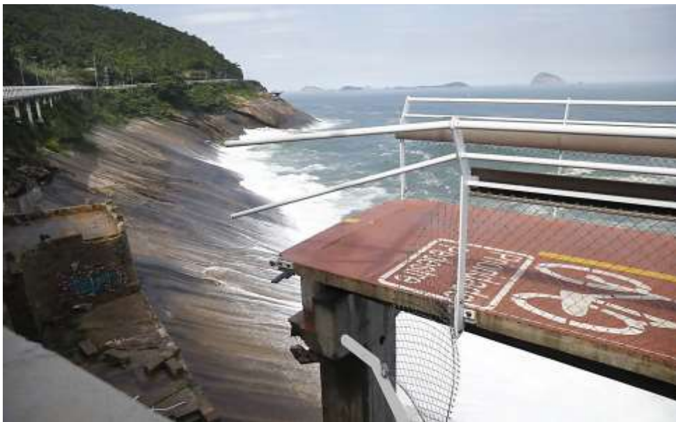
Figura 47 – Desabamento de parte da ciclovia Tim Maia no Rio de Janeiro em 21/04/2016
