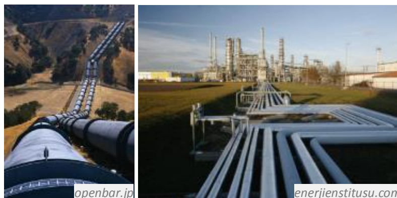
Figura 22. O gasoduto (como se fossem as linhas de transmissão, no caso de Energia elétrica) são grandes e caros, por terem que atravessar muitas vezes, milhares de quilômetros; uma indústria recebendo o gasoduto.
