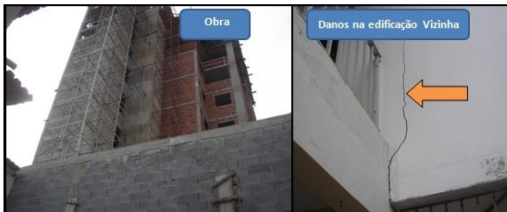
Figura 14 – Obra no município de Vitória e fissura na edificação vizinha.
