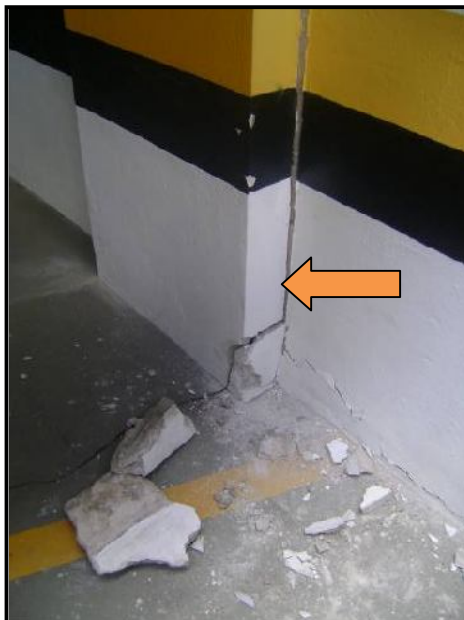
Figura 23 – Descolamento do muro lateral em relação à estrutura do pilar ocorrido no prédio multifamiliar vizinho frontal a obra.
