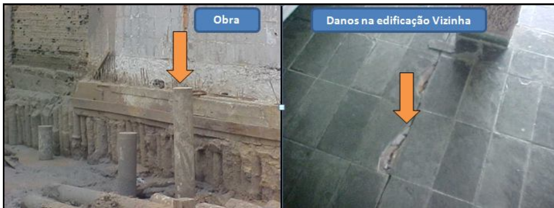
Figura 28 – Cravação de estacas na obra em andamento e fissuras no piso da edificação vizinha.
