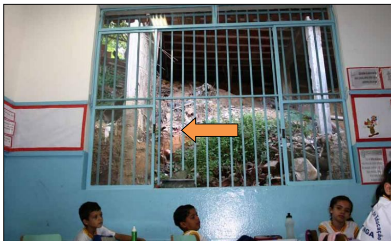
Figura 3 – Em Minas Gerais, obra vizinha provoca desmoronamento do muro da divisa com a escola.
