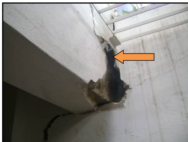
Figura 24 – Estrutura da viga e descolamento de muro da divisa com pilar, ocorrido no prédio multifamiliar vizinho frontal a obra.
