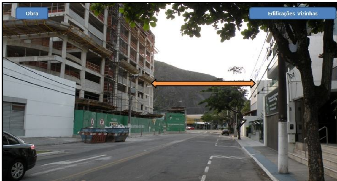
Figura 22 – Edifício comercial em construção e edificações vizinhas prejudicadas pelos danos e impactos gerados pela obra a partir do período de fundação.
