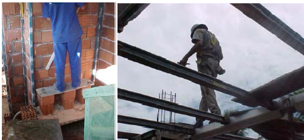
Figura 79 – Condições precárias e inseguras em canteiro de obras www.lsht.upe.poli.br
