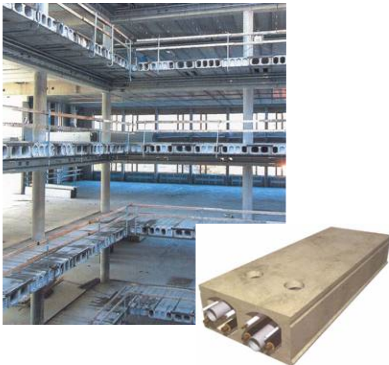
Figura 42 – Tubos e condutores elétricos nos alvéolos da laje Fonte: FEBE (2009)
