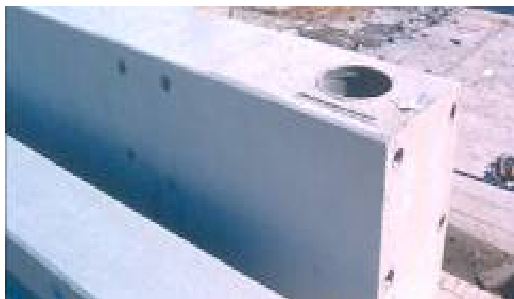
Figura 41 – Tubulação de descida de água em pilar Fonte: FEBE (2009)
