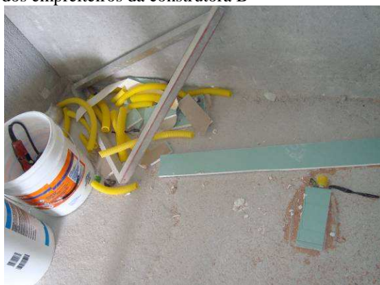
Figura 20 – Pilha de resíduos de responsabilidade dos empreiteiros da construtora B
