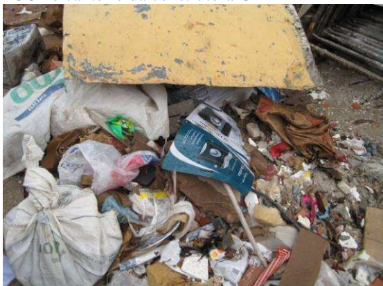
Figura 28 - Deposição de resíduos orgânicos e RCC no canteiro da construtora G
