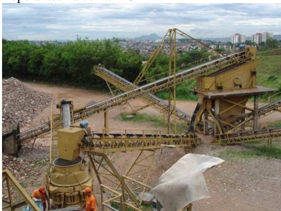
Figura 63 - Equipamentos de reciclagem inoperantes na usina MG 2
