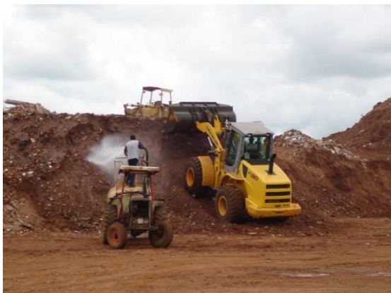
Figura 78 - Sistema de umectação das pilhas de RCC na usina SP 1
