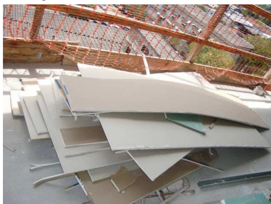
Figura 41 - Parte dos resíduos de gesso acartonado de um apartamento na Construtora C
