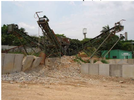
Figura 6 - Usina privada URBEM, instalada em 2005, em São Bernardo do Campo (SP)
