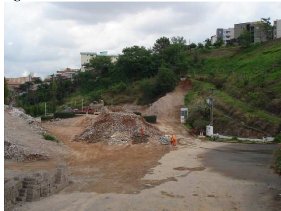
Figura 81 - Cinturão verde escasso na usina MG 3
