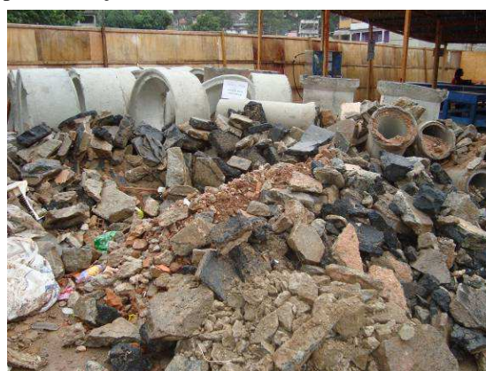
Figura 42 - Resíduos de demolição de pavimentação misturados na Construtora I
