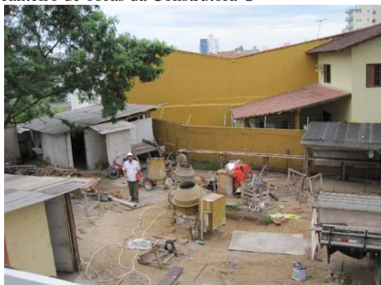
Figura 45 - Vista da disposição das áreas do canteiro de obras da Construtora G
