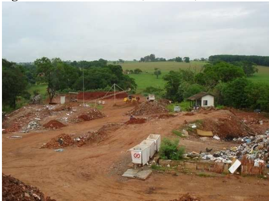
Figura 80 - Cinturão verde, ao fundo, da usina SP 1
