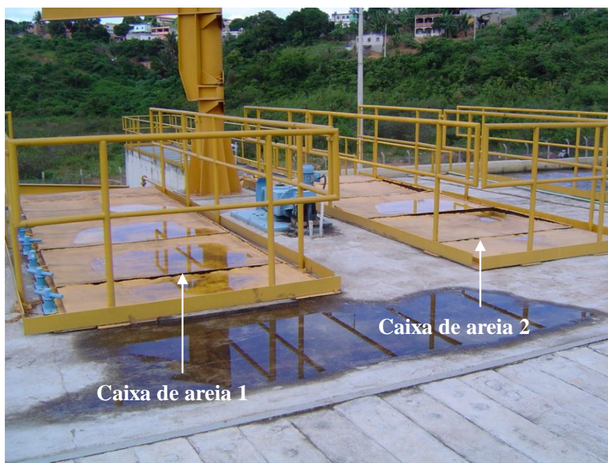
Figura 4.1 – Caixas de Areia da ETE Bandeirantes
