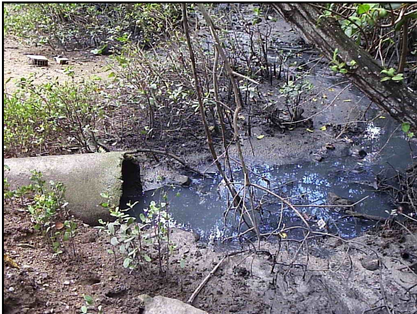
Figura 30. Bairro Resistência – Esgoto (f = 20° 16' 24" S λ = 40° 18' 59" W)
