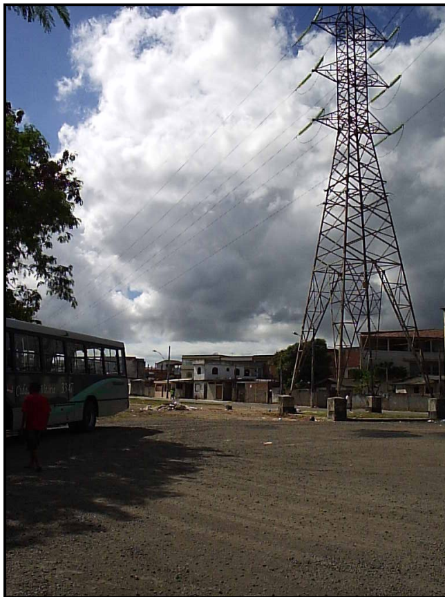
Figura 22. Bairro Maria Ortiz – Linha de Energia ( f = 20^{\circ} 15' 18'' S \lambda = 40^{\circ} 17' 49'' W )
