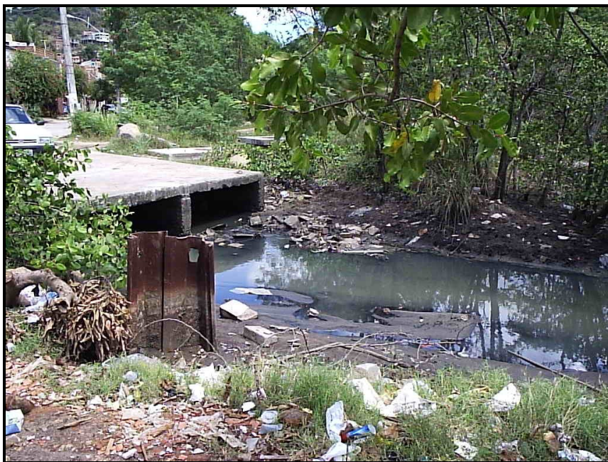
Figura 28. Bairro Resistência – Esgoto (f = 20° 16' 37'' S λ = 40° 18' 58'' W)
