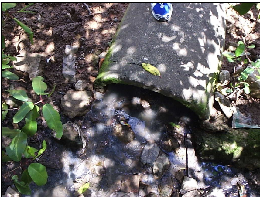
Figura 29. Bairro Resistência – Esgoto (f = 20° 16' 42'' S λ = 40° 18' 59'' W)
