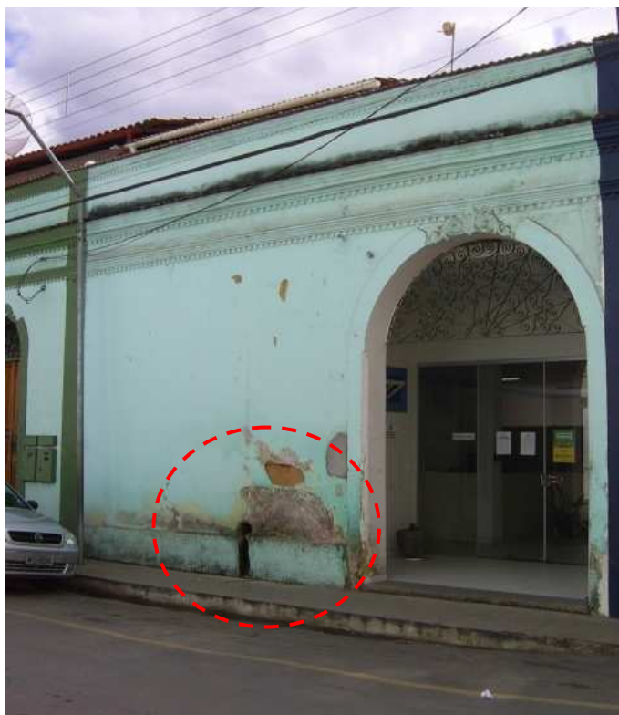
Imagem 33: Fachada de imóvel tombado em mau estado de conservação. Fonte: Arquivo da Autora - Abril/2013
