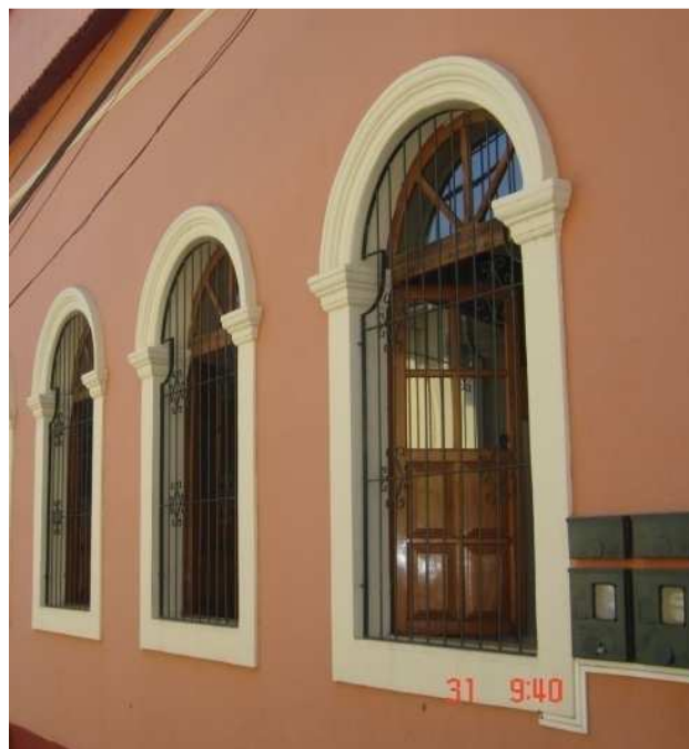
Imagem 35: Fachada de imóvel tombado com grades nas janelas, interferindo na caracterização da fachada original. Fonte: Arquivo da Autora - Julho/2008
