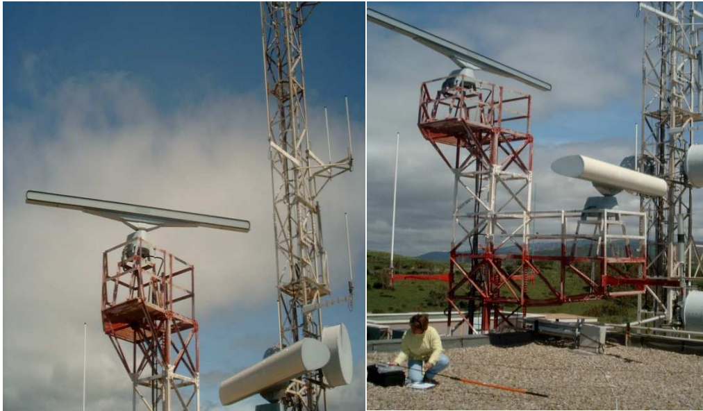
Centro Zonal de Salvamento Marítimo. Tarifa. Antenas de radares Banda X y Banda S.
