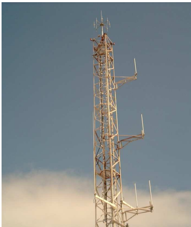
Centro Zonal de Salvamento Marítimo. Tarifa. Antenas de comunicaciones y localizadoras.
