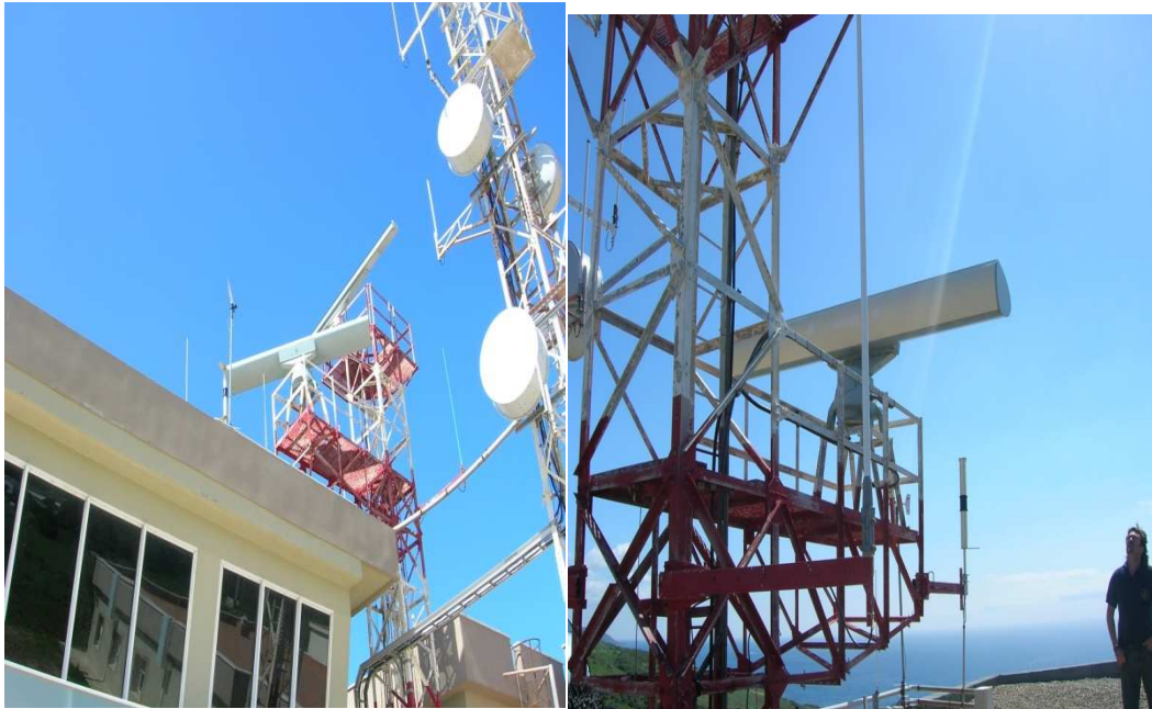
Centro Zonal de Salvamento Marítimo. Tarifa. Centro de operación y mantenimiento.
