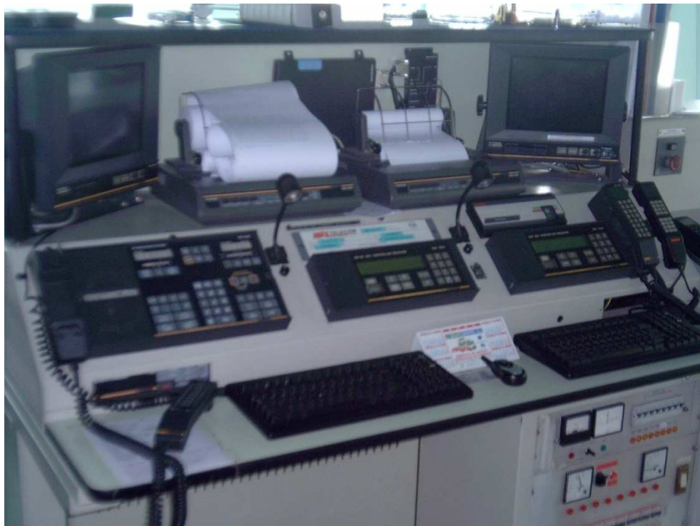
Buque portacontenedores Superfast Canarias. Consola de Radiocomunicaciones del GMDSS.
