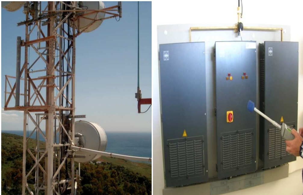
Centro Zonal de Salvamento Marítimo. Tarifa. Radioenlace del radar de Ceuta. Unidad de alimentación (centro) y unidades de transmisión (izq. y dcha) de los dos radares.
