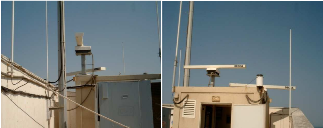
Centro de Salvamento Marítimo, Cádiz. Antenas del Radar 1 y del Radar 2.
