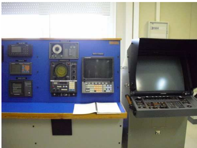
Equipos de Radiolocalización, Radar 1, Estación Universidad de Cádiz.
