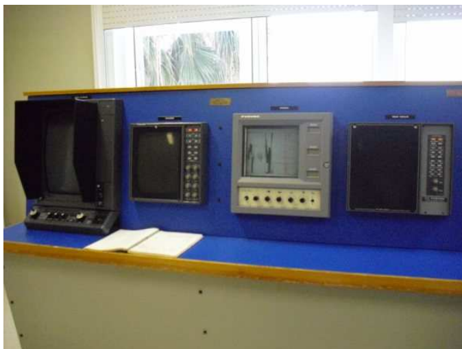
Equipos de Radiolocalización, Radar 2, Estación Universidad de Cádiz.
