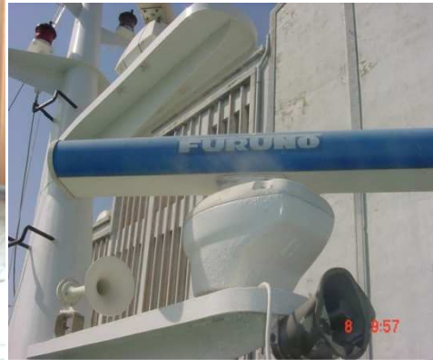
Antena del Radar 1.
