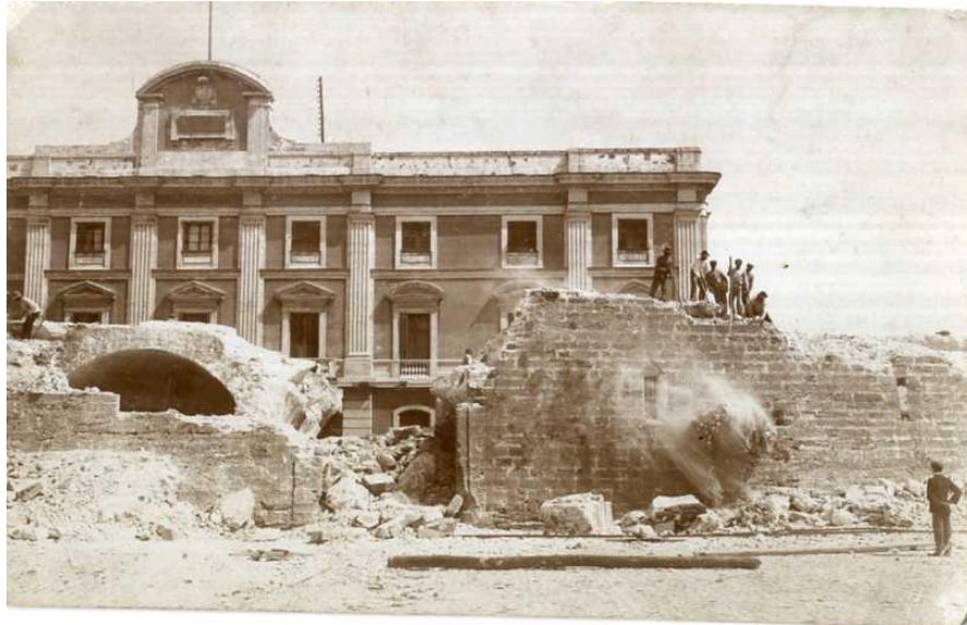
Figura 11: Derribo de murallas. Fuente: Archivo particular de José De la Fuente Campodarbe .
