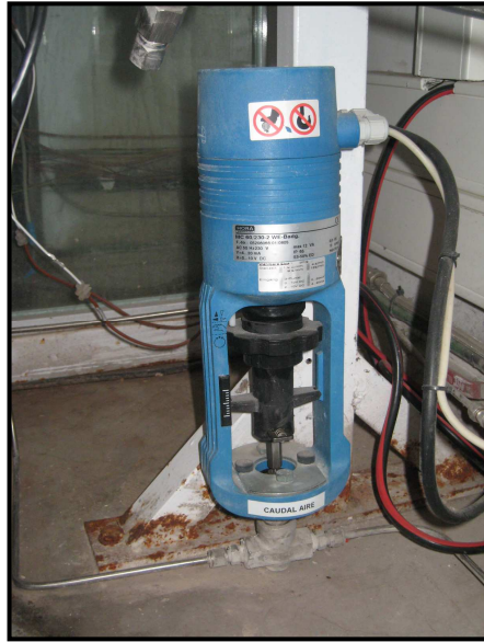
Figura 53. Fotografía de la electroválvula reguladora del caudal de aire.
