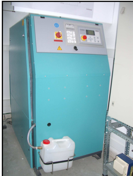
Figura 40. Fotografía del compresor de aire
