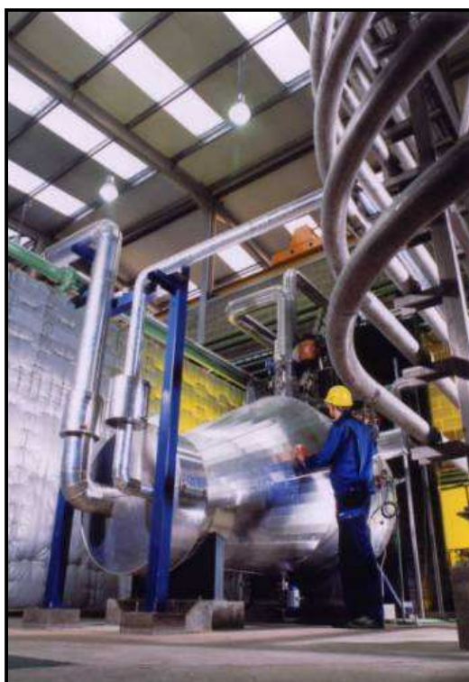
Figura 23. Vista parcial de la instalación del proceso AquaCat.
