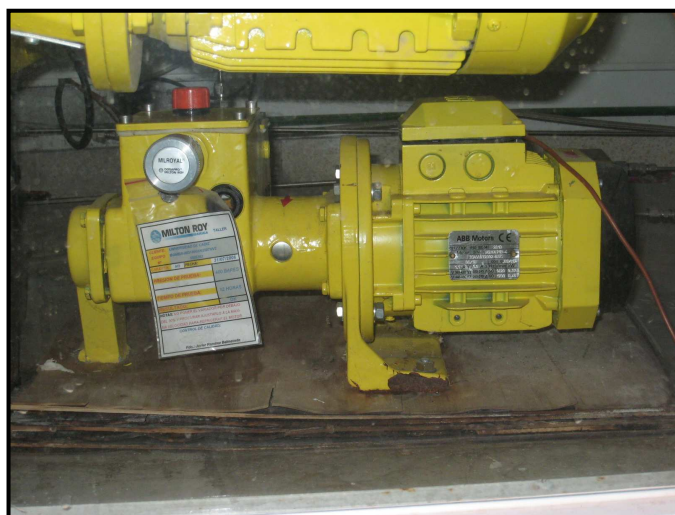
Figura 39. Fotografía de la bomba de alta presión situada en la segunda línea de alimentación.
