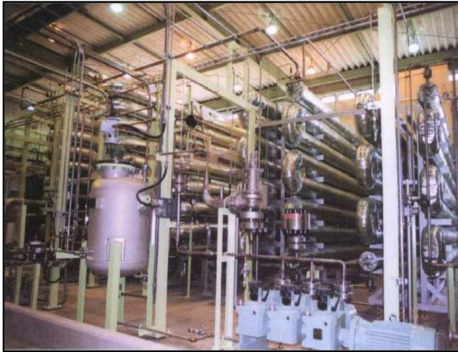
Figura 22. Vista de la planta de Shinko Pantec.
