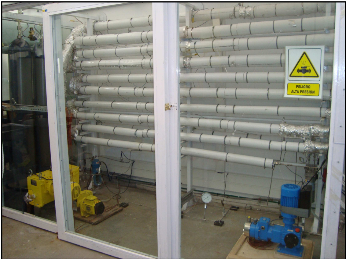
Figura 35. Vista general de la planta piloto de oxidación microtérmica de la UCA.
