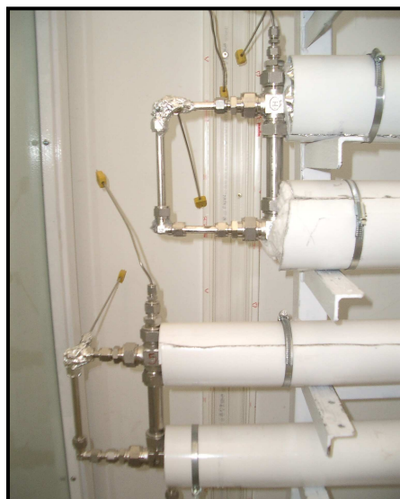
Figura 44. Detalle de las tuberías de unión de los intercambiadores de calor de tubos concéntricos construidos para precalentar la alimentación líquida y gaseosa.
