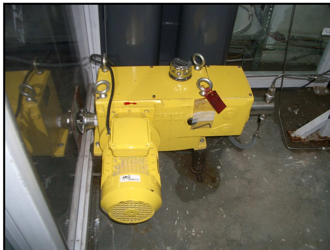
Figura 38. Fotografía de la bomba de alta presión situada en la primera línea de alimentación.
