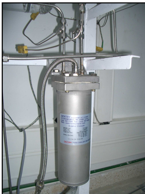
Figura 46. Fotografía del enfriador multietapa.
