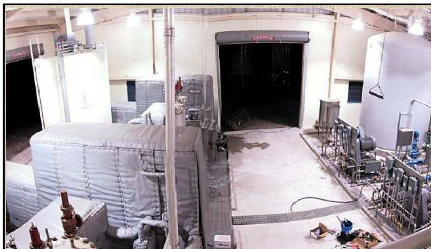
Figura 20. Vista interior de la planta Hydrosolids ® .
