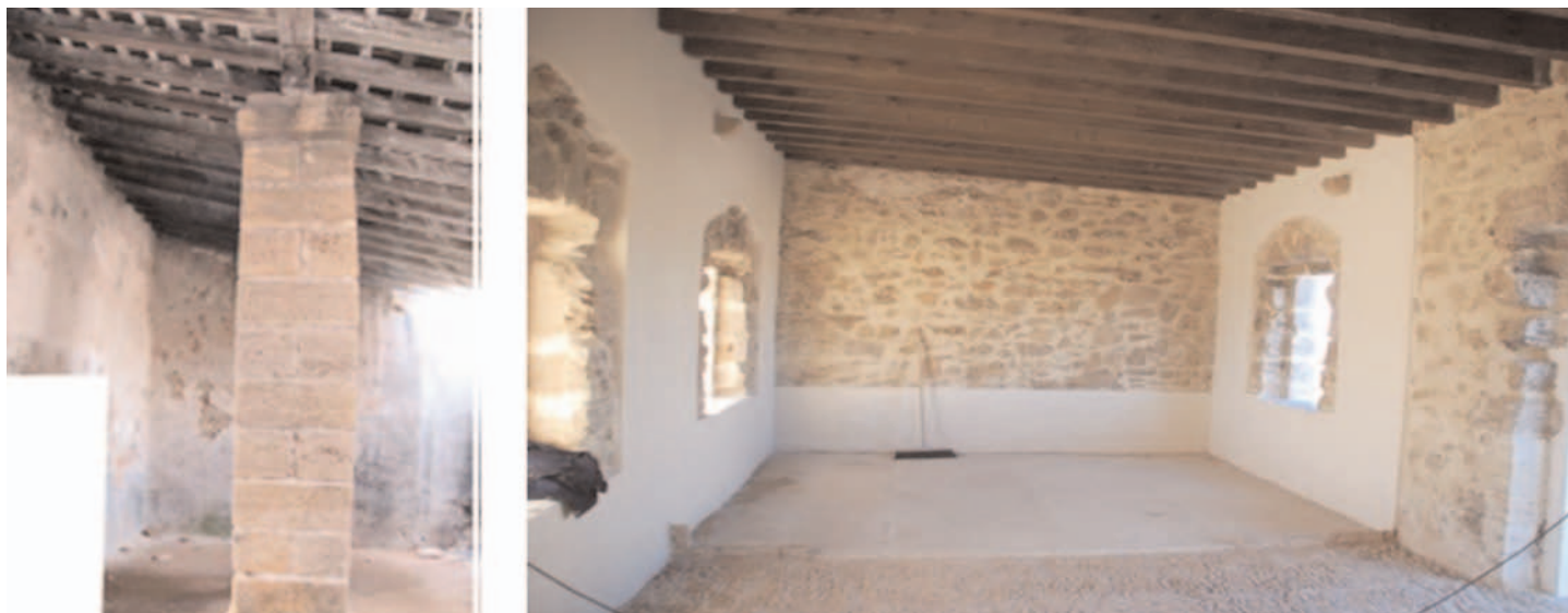
Fig. 9. Fotografías del aspecto de la cubierta existente y de la nueva ejecutada en la misma tipología pero con madera y cerámica tratada.
