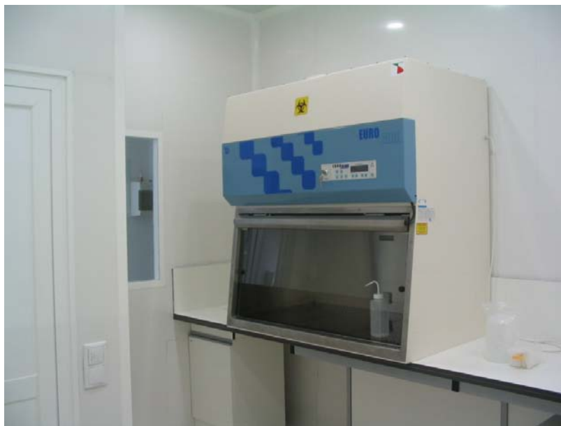
Figura 4-24. Sala limpia clase ISO-6 equipada con una cabina de flujo con filtro ULPA y filtro de carbono.
