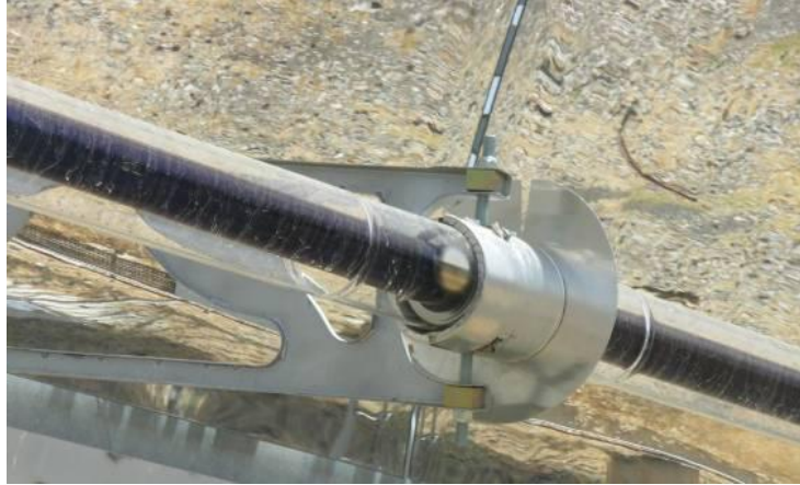
Ilustración 4: Tubo absorbedor con suciedad.
