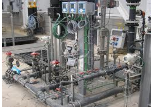
Ilustración 93. Planta de tratamiento.
