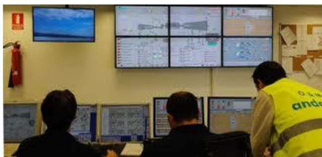
Ilustración 64. Sala de control Andasol I.
