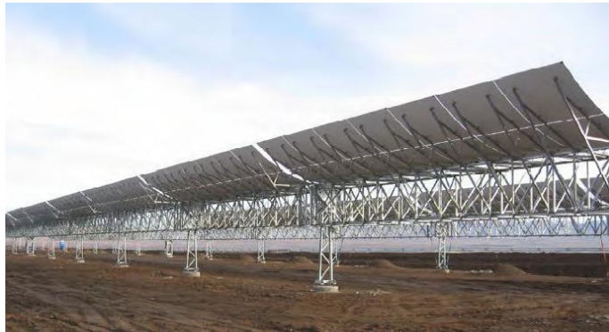
Ilustración 51. Filas de colectores ET-100. (Fuente: Solar Millennium AG, 2009)
