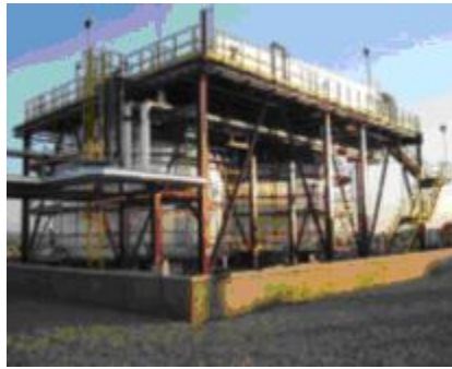
Ilustración 29. Depósitos de sales fundidas.
