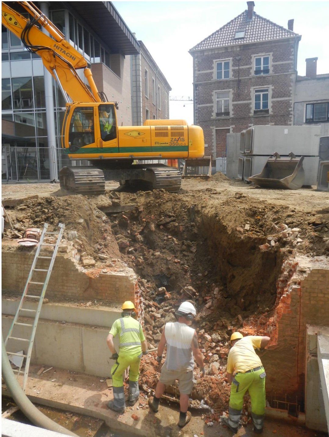
Afbeelding 39: Het lokaal doorzagen van de kaaimuur in functie van de ontmanteling van de oude en de plaatsing van een nieuwe.
