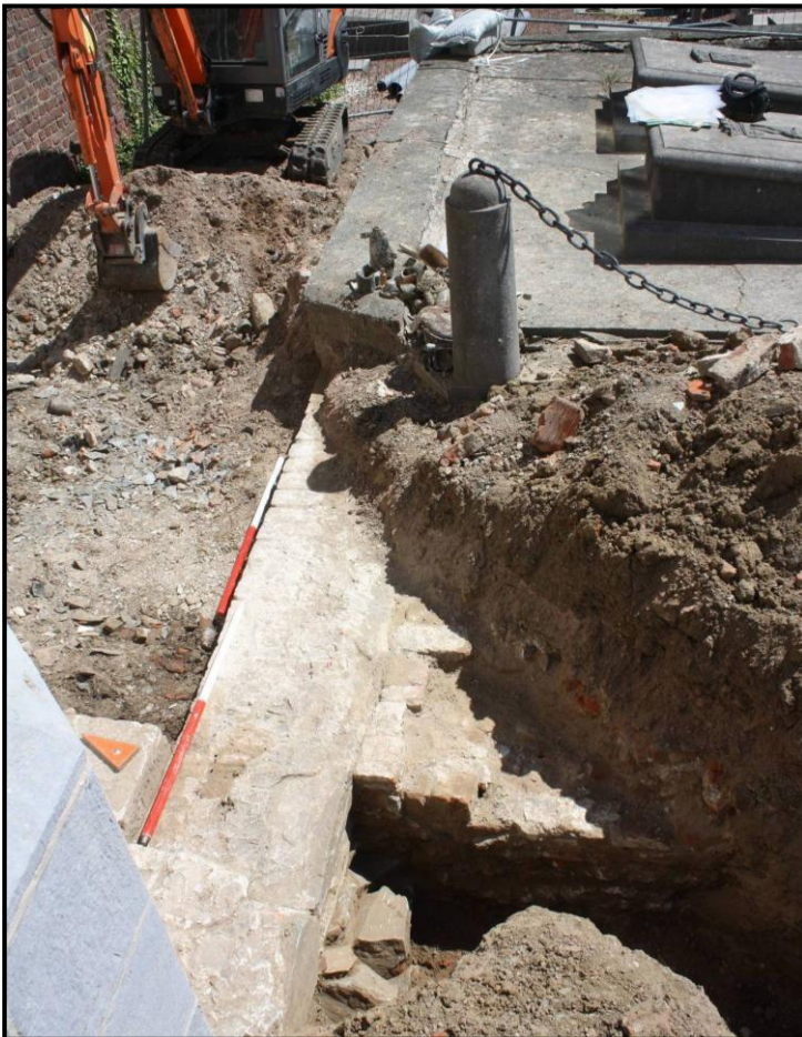
Figuur 67: Zicht op de muurstructuren S602 en S603 in sleuf 22, ten ZO van het huidige koor van de kerk.
