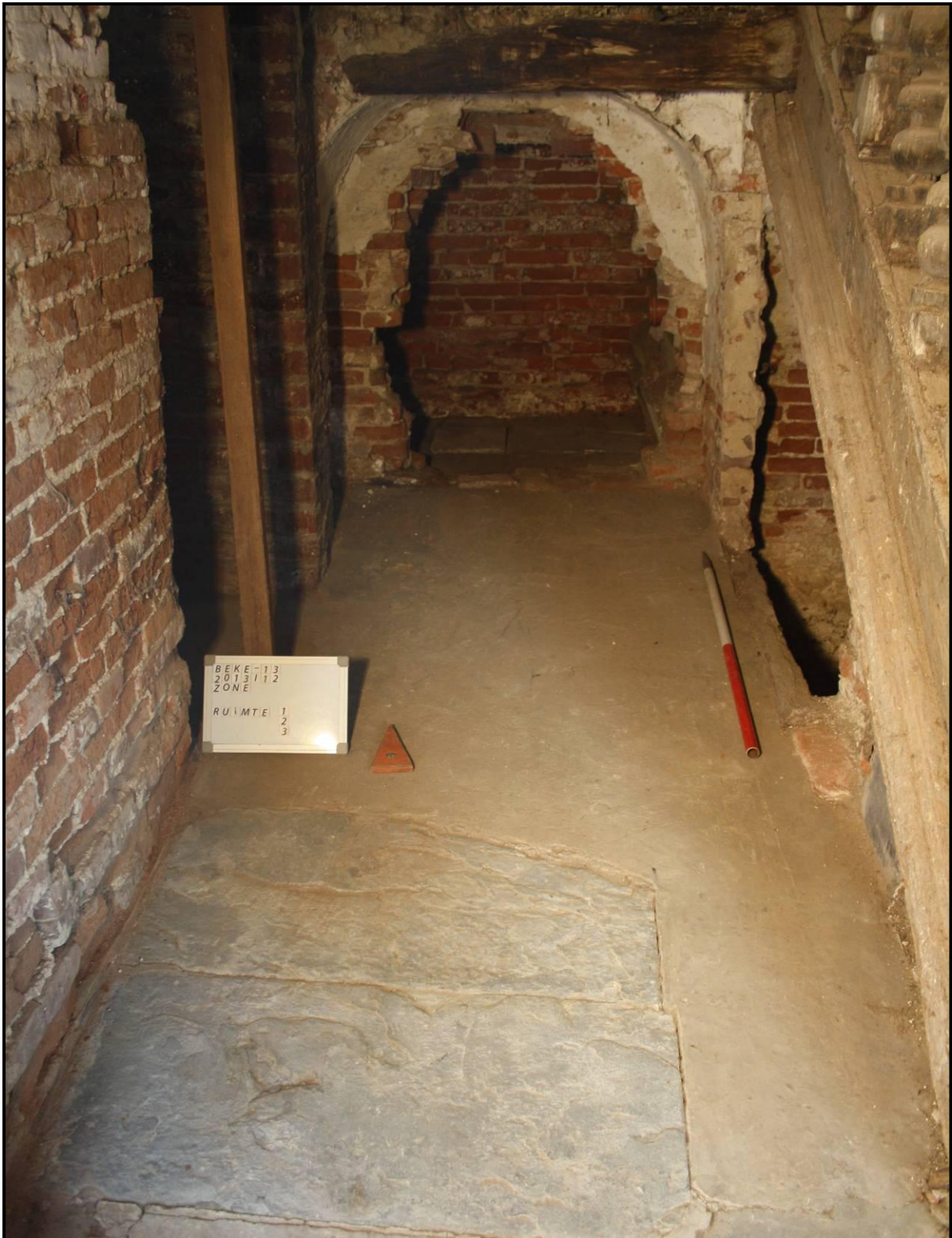
Figuur 39: Vlak 1 van ruimte 3 in zone 5/sleuf 23 met op achtergrond ruimte 1 en rechts ruimte 2. De blauwe en grijze tegels in de ruimte op de achtergrond zijn hergebruikt en lagen daar los.
