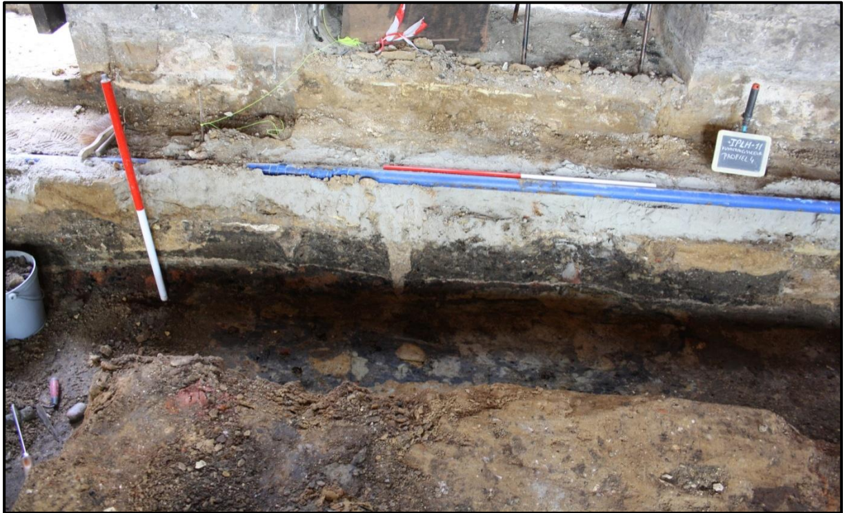
Figuur 34: Zicht op funderingsprofiel 4 waar ongeveer halverwege het dunne bandje zichtbaar is van een lemig gelig pakket.
