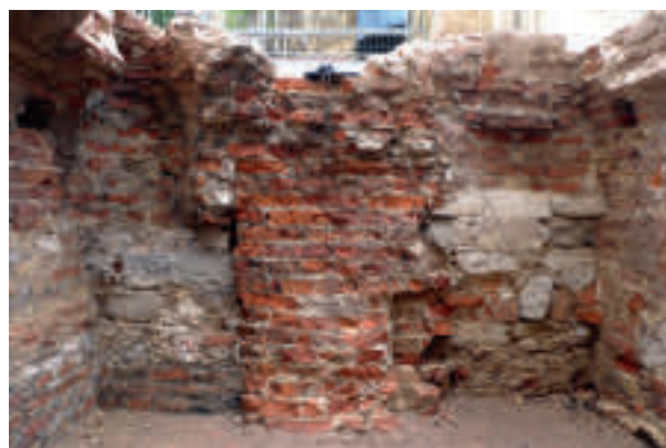
afb. 16: Een restant van tussenmuur S8 en de rommelige invulling van muur S9 links en rechts ervan, restanten van de latere versterking van de brug (Stad Gent, De Zwarte Doos, Stadsarcheologie)
