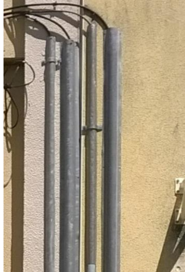
Figura 66 – Tubo de subida metálico[43]
