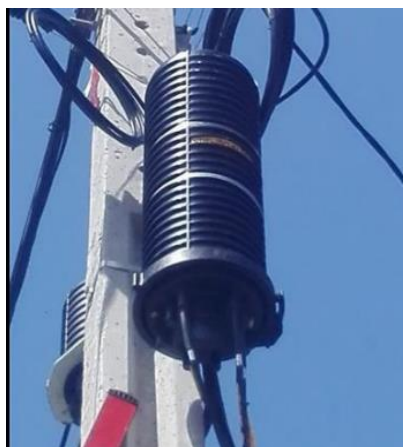
Figura 92 – JSO em Poste[43]
