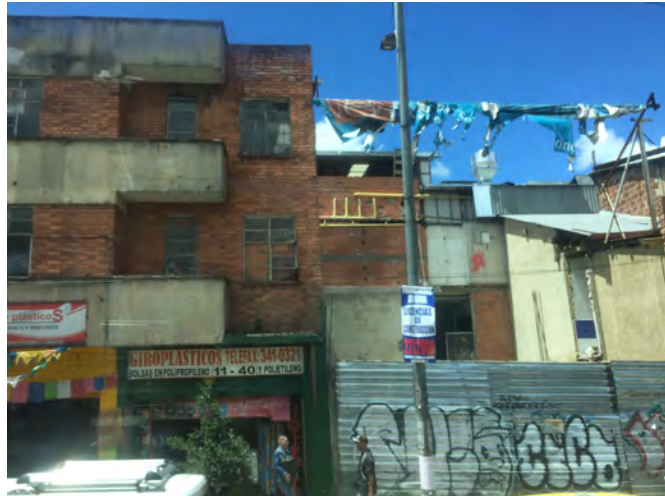
Imagen 27. Edificio abandonado y en deterioro, Calle 11. Fotografía propia.
