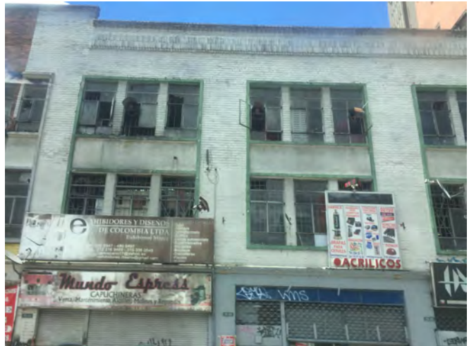
Imagen 28. Edificio abandonado y en deterioro, Calle 19. Fotografía propia.
