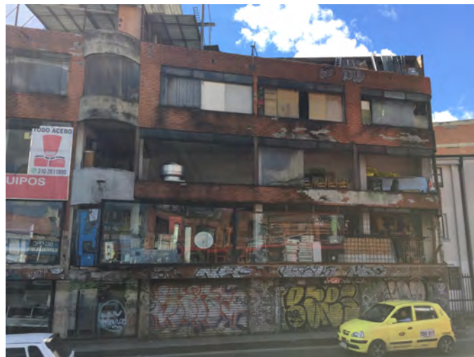
Imagen 26. Edificio abandonado y en deterioro extremo, Calle 74. Fotografía propia.
