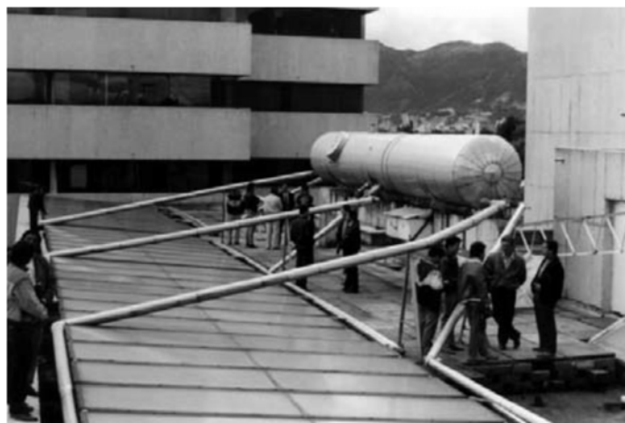
Figura 2. Calentador de la cafetería de la antigua Empresa de Energía de Bogotá (EEB), construido en 1983 por el Centro Las Gaviotas (140 m 2 de colectores, tanque de 12 000 litros) y desde entonces en operación.
