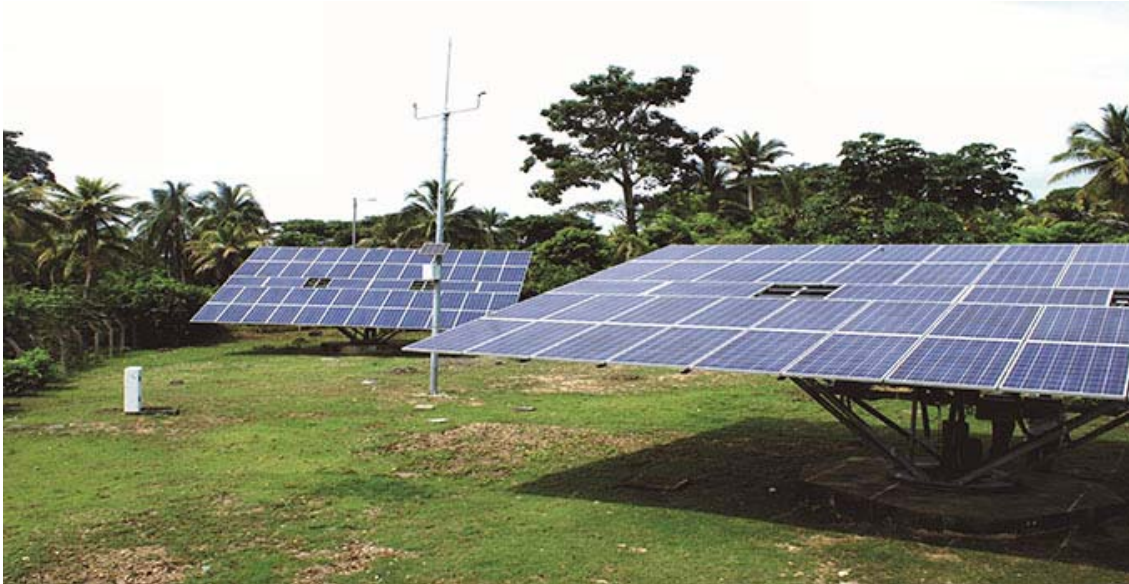
Paneles solares en Isla Fuerte (Bolívar)
