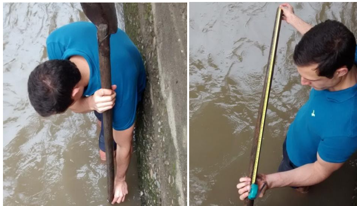
Figura 18- Medida de la socavación real en el estribo derecho
