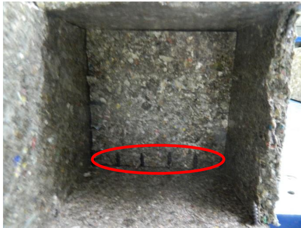
Figura 60. Falla en el ensamble de los rigidizadores
