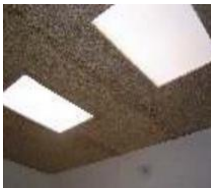
Figura 25. Cielorraso de Ecoplak Tomado de Riorion S.A. (S.F)
