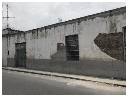
Fotografía 4. Deterioro de Inmuebles
