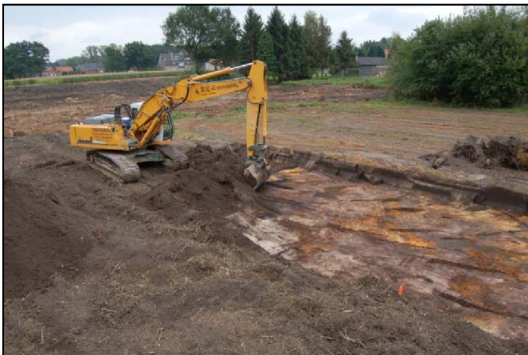
Fig. 8: Zicht op de aanleg van de wegwakker na het ontbossen van het terrein. (Bron: ARON bvba)
