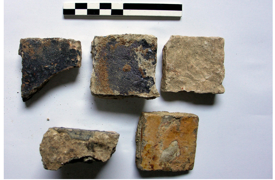
Verschillende voorkomende beschadigingen: boven: gefragmenteerde tegel, vastgeklit puin, overlangse breuk. Onder: dik mortelpakket van het mortelbed, afschilfering van het glazuur.
