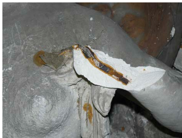
FIG. 36 Schade door gecorrodeerde doken (foto M. Buyle)
