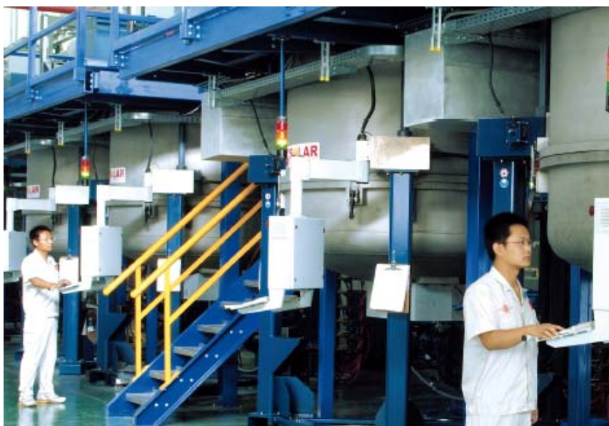
5. ábra Szilícium öntvény előállító berendezések a Yingli Green Energy Baodingi (Kína) üzemében.
