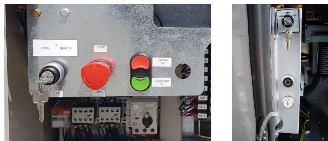
Figura 16 - Comutadores de comando (Local e Remoto)
