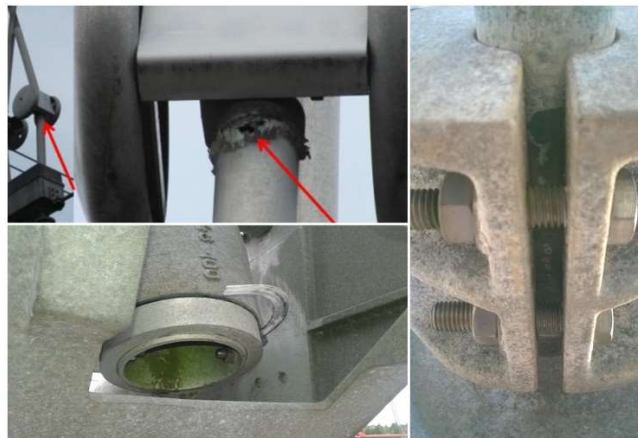
Figura 51 - Anomalia detetada por corrosão na cadeia cinemática de seccionadores
