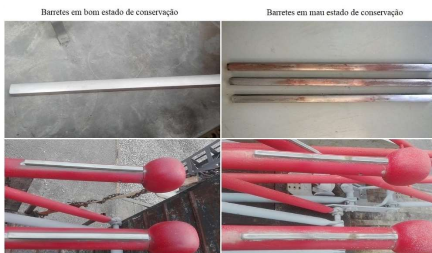
Figura 46 - Anomalia causada por desgaste elétrico no contacto móvel (barretes) de um SX
