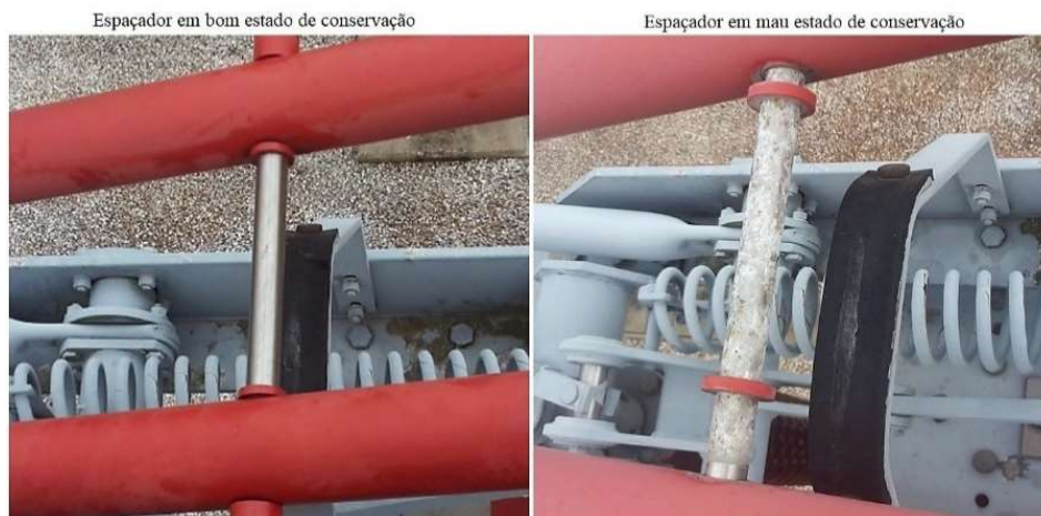
Figura 55 - Anomalia registada por corrosão no espaçador do eixo superior de um SX
