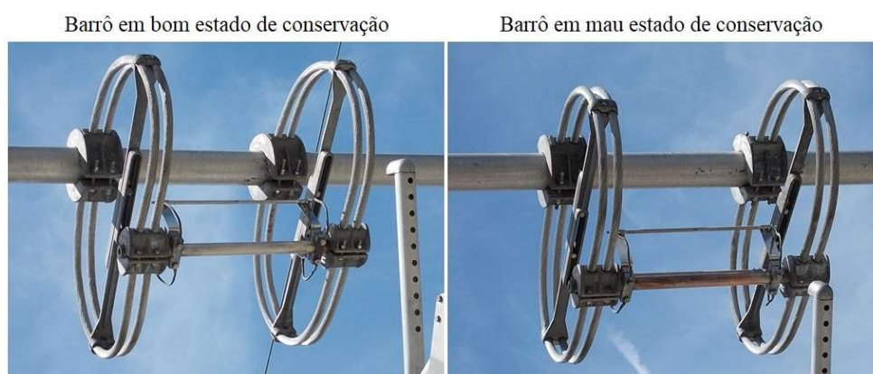
Figura 47 - Anomalia causada por desgaste elétrico no contacto fixo (barrô) de um SX
