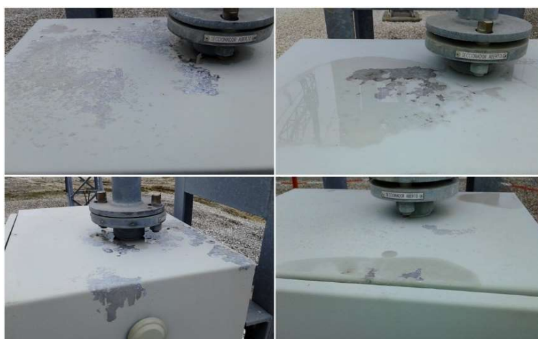
Figura 53 - Anomalias registadas no comando associadas ao estado de degradação
