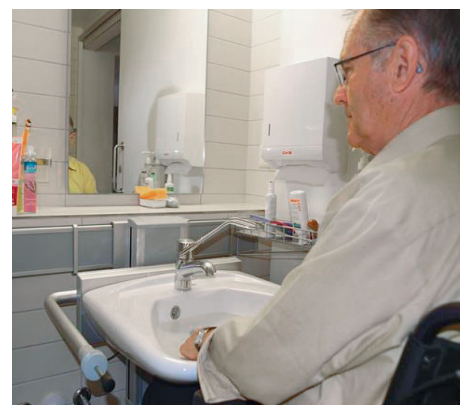
Mechanisch tief gestelltes Lavabo für Benutzung im Rollstuhl.
