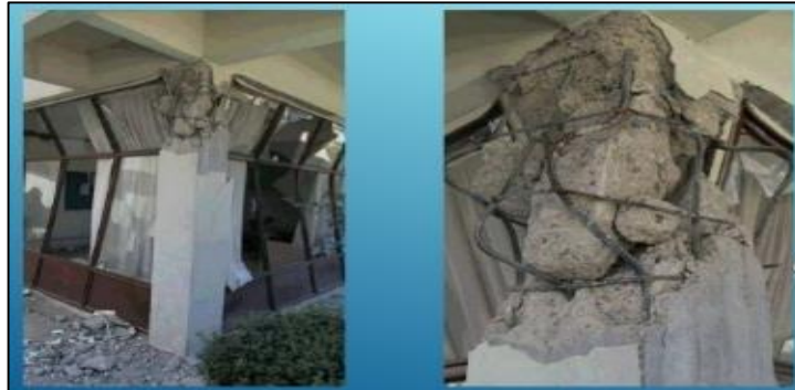
Figura 1 elementos en concreto con falla por compresión.
