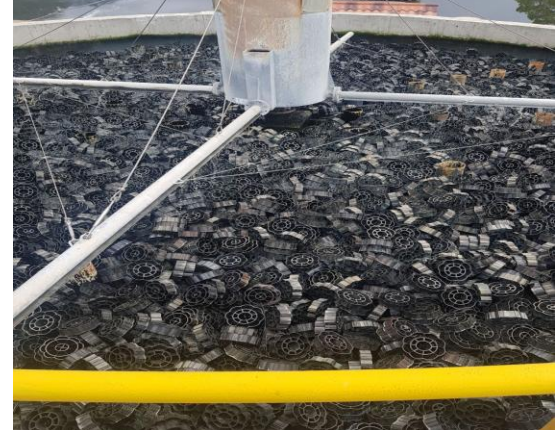
Ilustración 13 Parte alta del filtro
