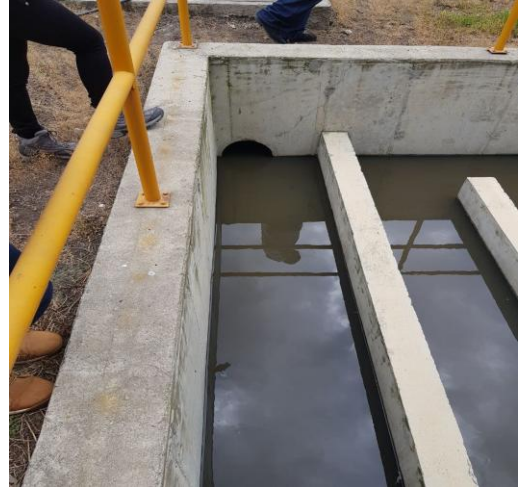
Ilustración 19 Salida del agua de la PTAR
