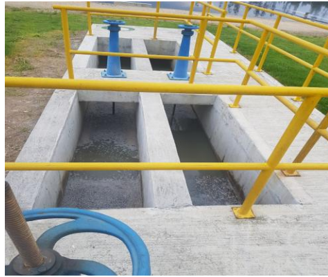
Ilustración 7 Desarenadores y válvulas
