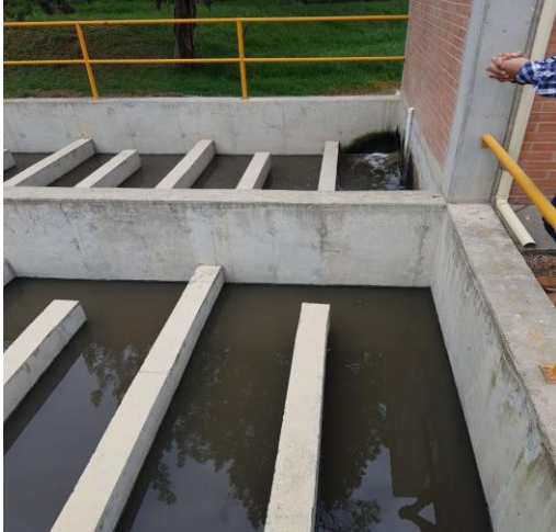
Ilustración 20 Tanque de contacto
