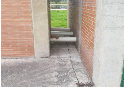
Ilustración 12 Tubería de las 3 bombas
