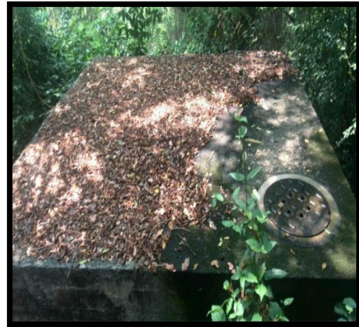
Ilustración 30 Tanque para el lavado
