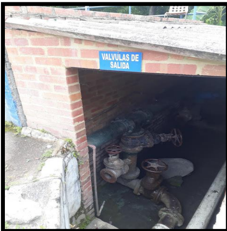
Ilustración 29 Válvulas de filtros y retro
