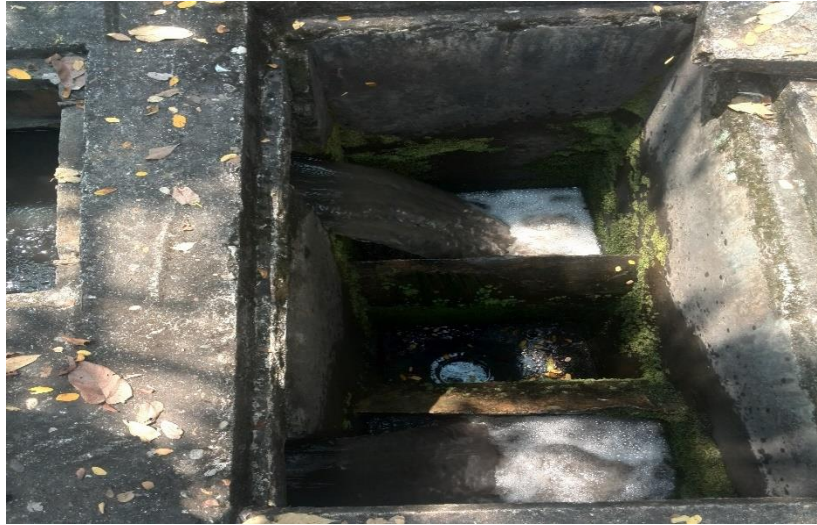
Ilustración 11 Repartidor de caudales
