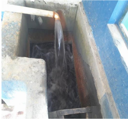
Ilustración 13 Punto de adición del coagulante
