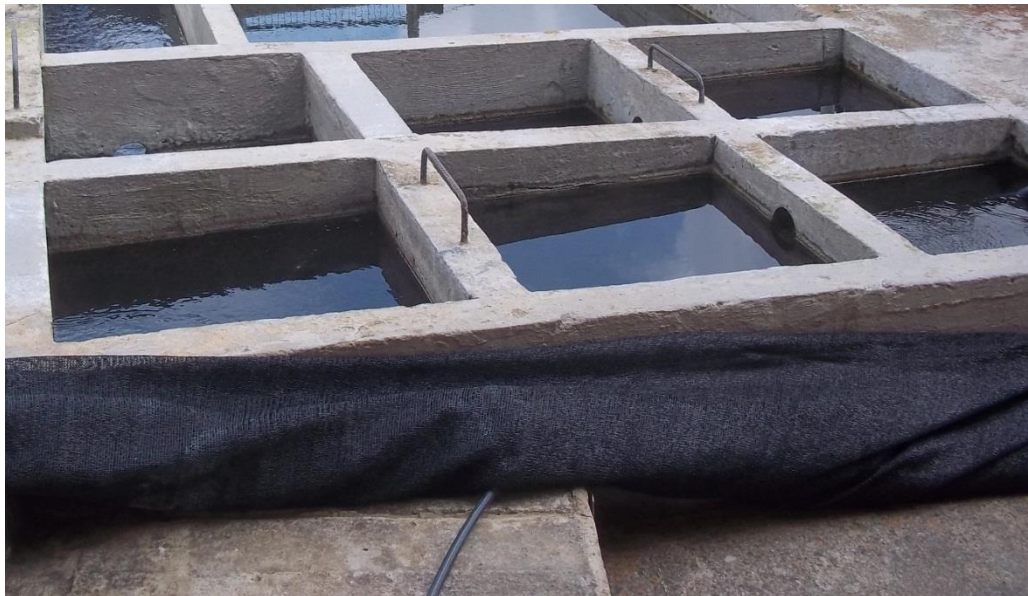
Fotografía 10. Floculador tipo Alabama
