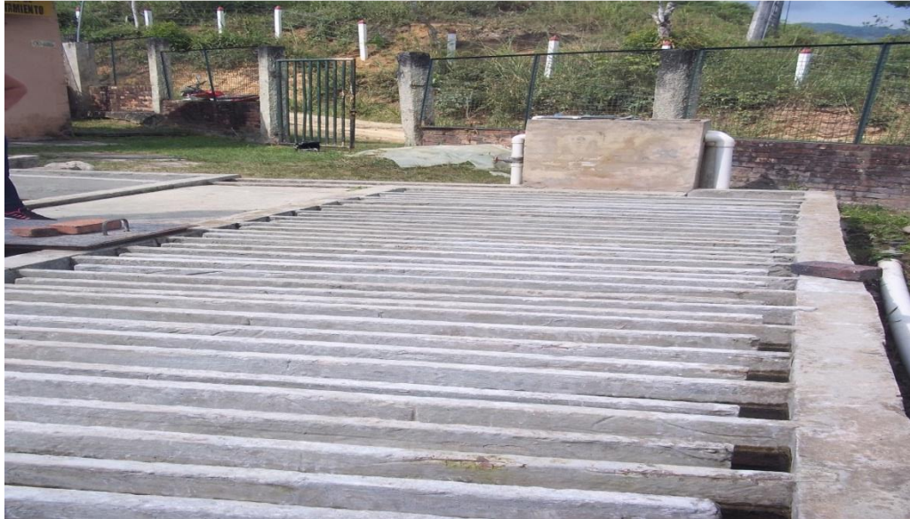
Fotografía 7. Floculador de flujo horizontal
