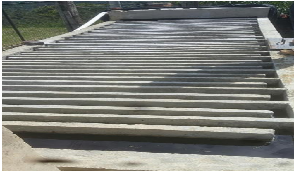
Fotografía 8. Floculador de flujo horizontal
