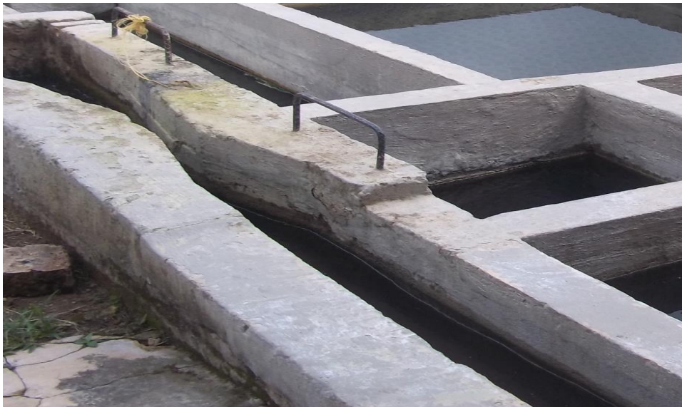
Fotografía 6. Canaleta Parshall sección transversal
