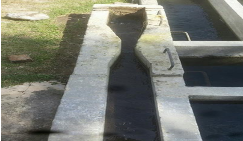
Fotografía 5. Canaleta Parshall sección longitudinal
