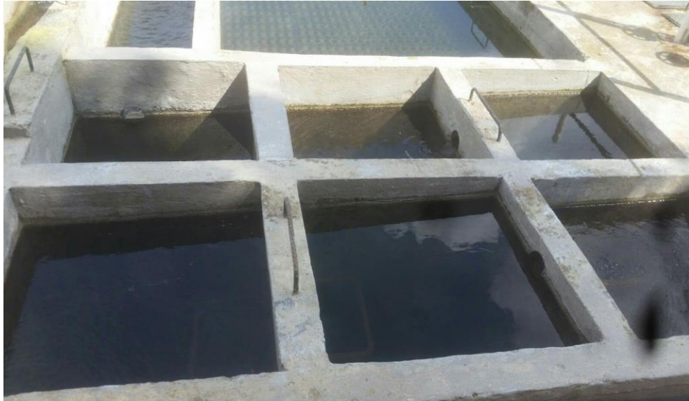
Fotografía 9. Floculador tipo Alabama
