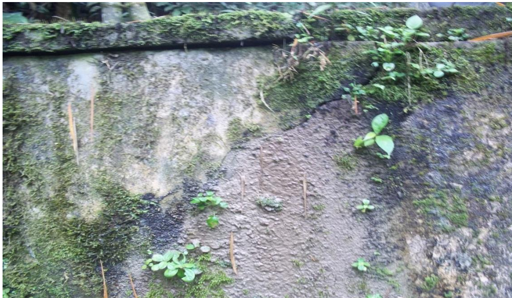
Fotografía 4. Agrietamiento en el tanque sedimentador
