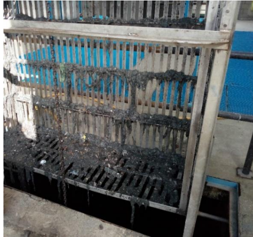
Foto 1: Cribas PTAR Funza
