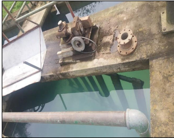
Fotografía de Ludwig Correa-La Palma 2018 Imagen 23. Floculadores mecánicos fuera de servicio.
