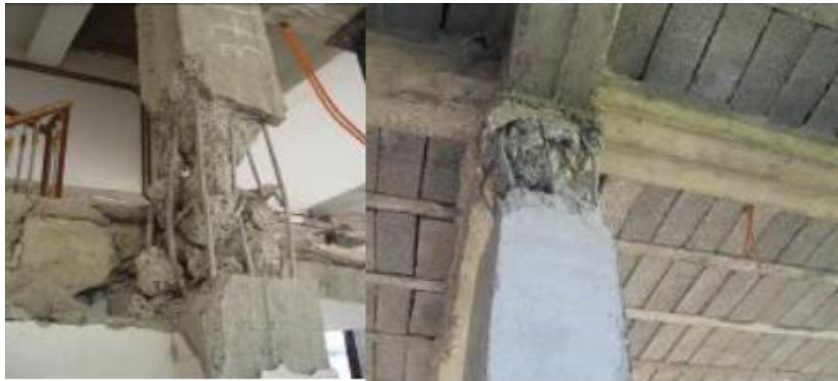
Figura 7. Daño generado por compresión
