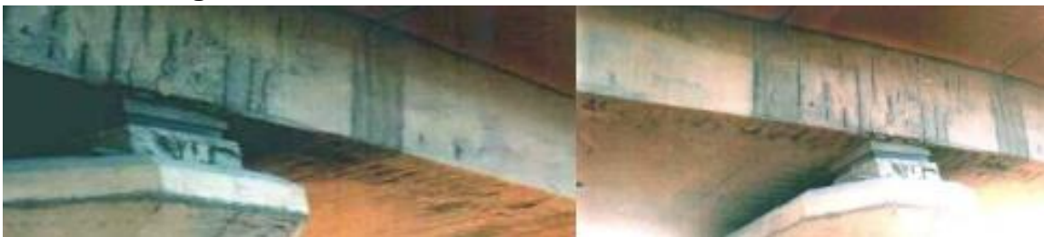
Figura 4. Efecto de carbonatación en las estructuras
