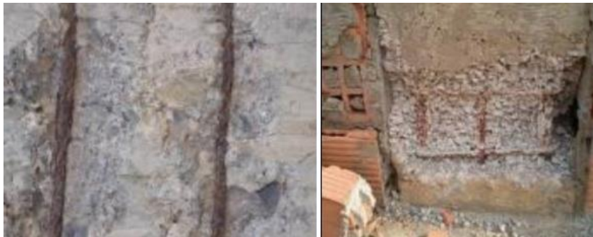
Figura 5. Efecto de corrosión en el acero
