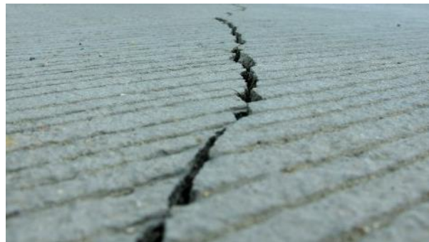
Figura 11. Fisura por movimiento de la base
