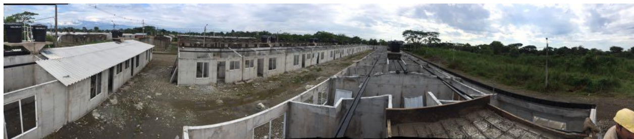
Figura No 4. Panorámica del estado actual de las viviendas. Fuente: Autor.
