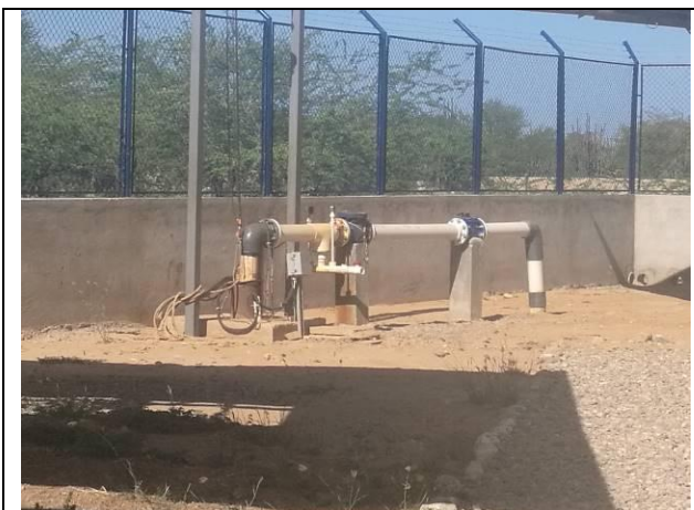
Foto 1: Pozo profundo de producción con caudal de 27 l/s.
