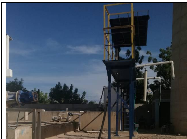
Foto 9: Sistema de bombeo para el llenado de los carrotanques.
