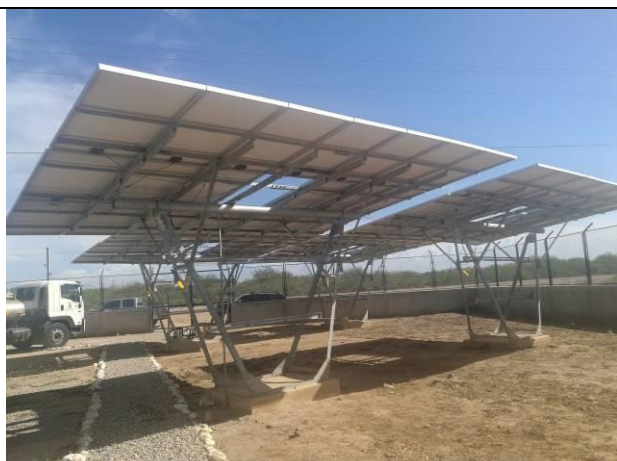
Foto 2: Sistema de generación fotovoltaico para suplir parte de la energía consumida.
