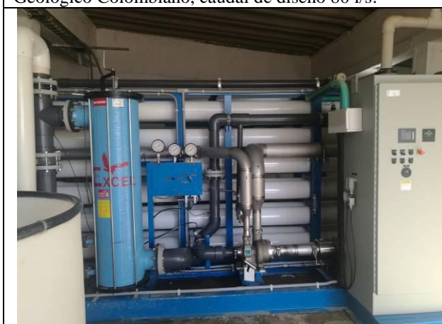
Foto 7: Planta de ósmosis inversa para tratar agua de pozo salobre.
