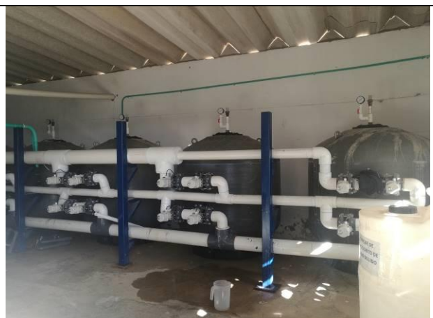
Foto 6: Sistema de filtración a presión, con lecho múltiple.
