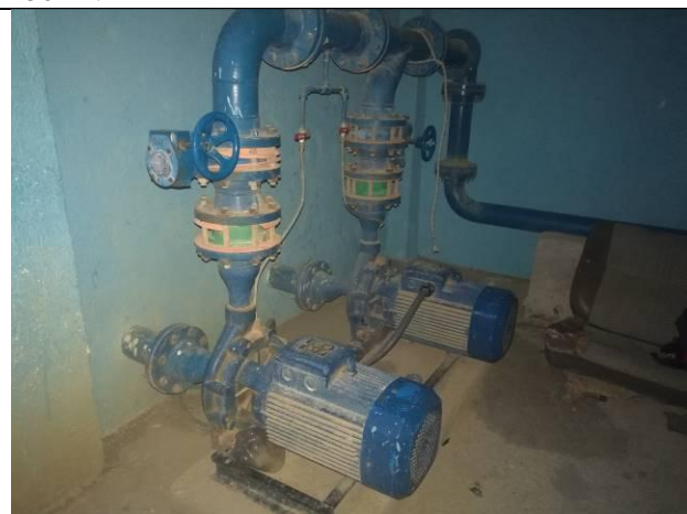
Foto 12: Estación de bombeo para entregar agua por la red de distribución a un sector del municipio.
