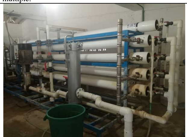
Foto 8: Planta de ósmosis inversa para tratar agua de mar.
