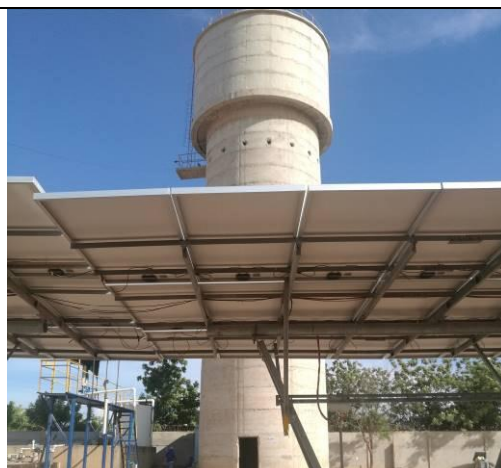
Foto 10: Tanque de almacenamiento con capacidad de 250 m 3 .
