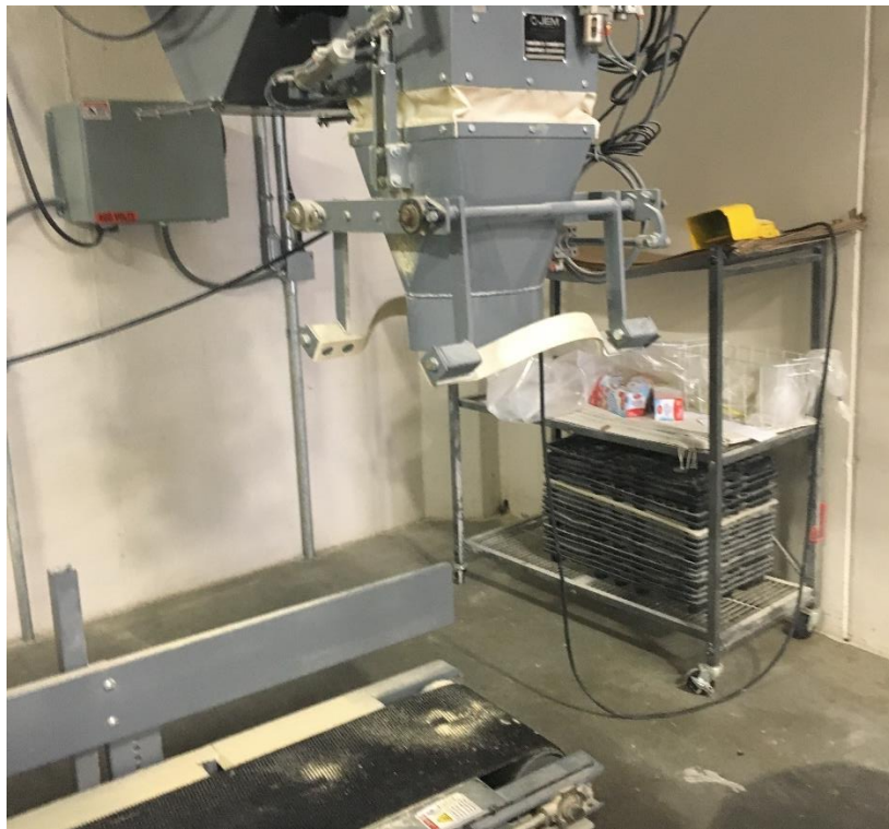
Figure A-4. Discharge bin boot
