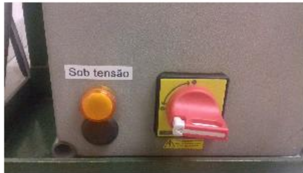
Figura 3 – Seccionador e indicador luminoso de tensão.
