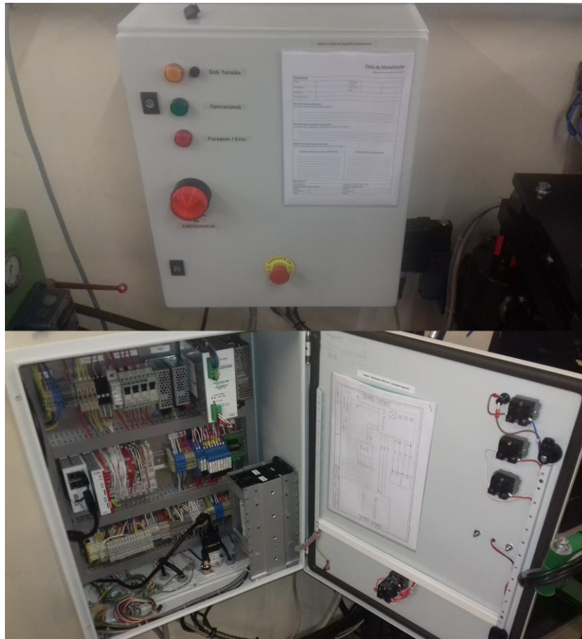
Figura 3.20 – Quadro Elétrico do Manipulador
