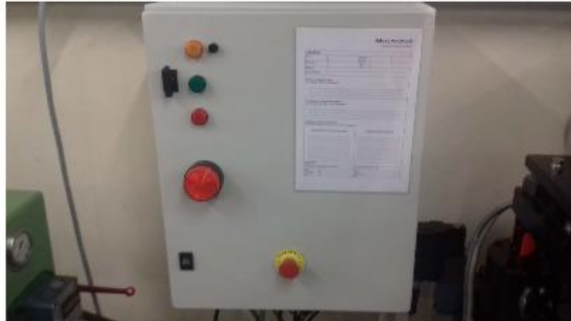
Figura 8 – Quadro Elétrico Manipulador.
