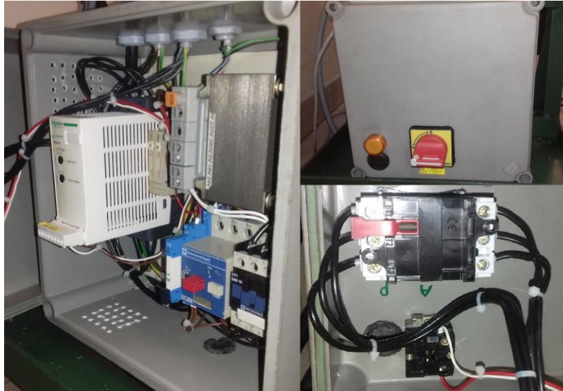
Figura 3.19 – Quadro elétrico da central hidráulica.
