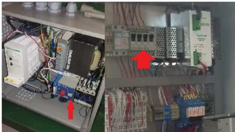
Figura 2 – Disjuntor-motor (esquerda) e disjuntor termomagnéticos (direita).
