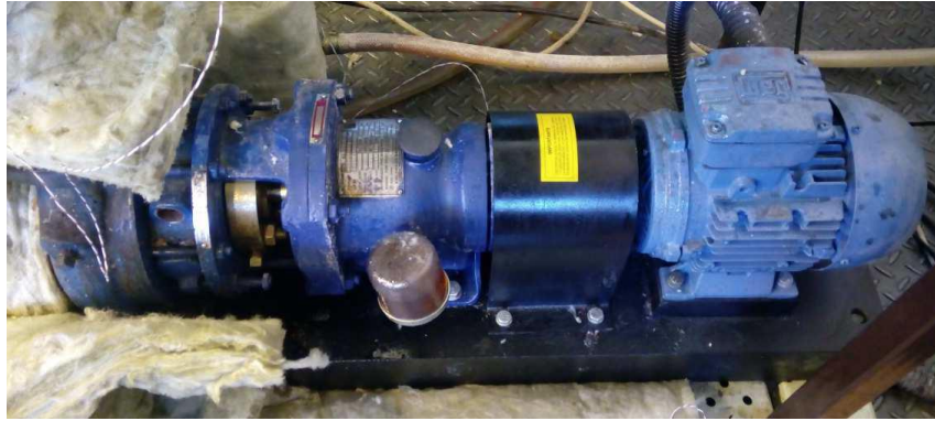
Figura 3.5: Grupo de bombagem (Trindade, 2018).
