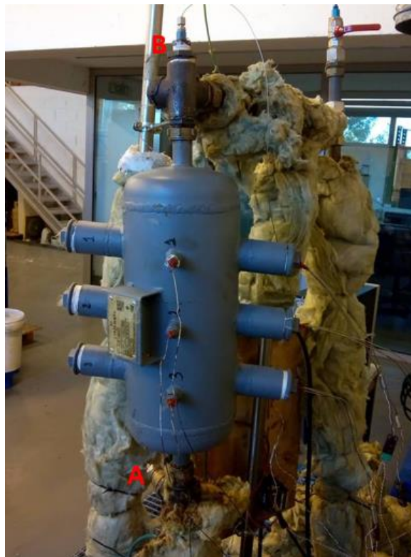
Figura 6.4: Permutador de testes e tomadas de temperatura: (A) entrada do permutador; (B) saída do permutador;
