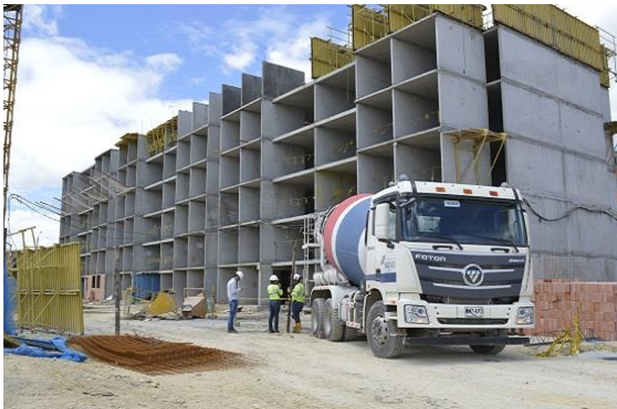
Figura 31. Proyecto VIS materializado con el sistema constructivo Outinord en Bogotá Colombia. Fuente: http://www.bogota.gov.co/article/temas-de-ciudad/habitat/repunta-vivienda-de-interes-social-en-bogota
