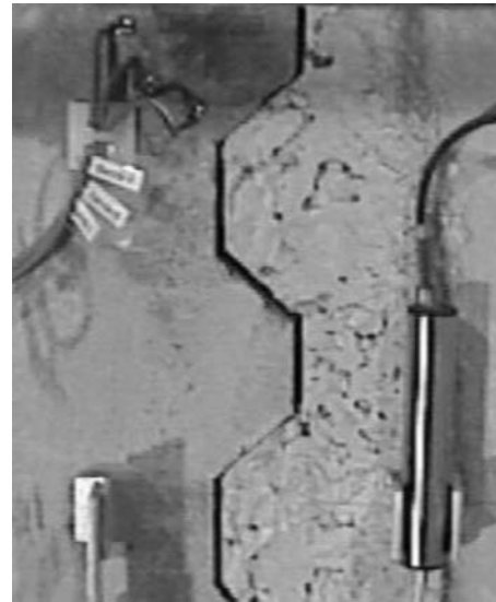
Figura 8. PC-C. Detalle de la junta instrumentada donde se aprecia la separación entre las llaves.
