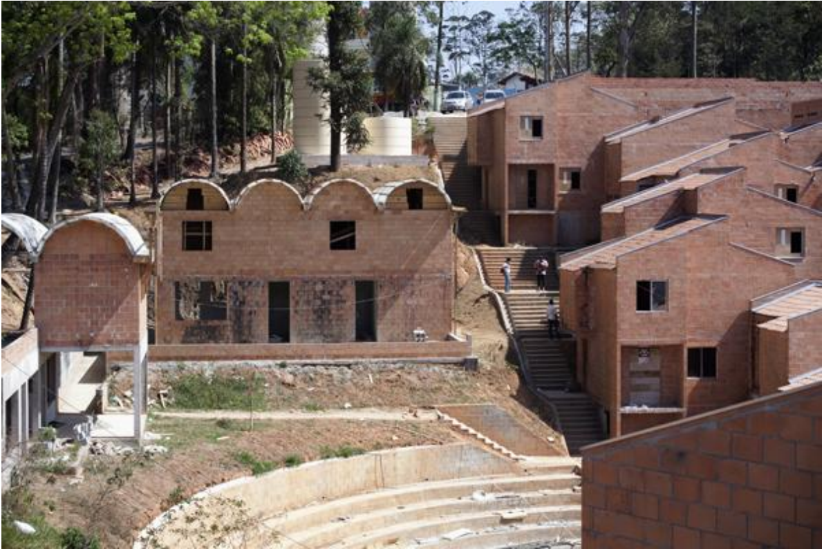
Escola – Infraestrutura inacabada. Fonte: Usina.
