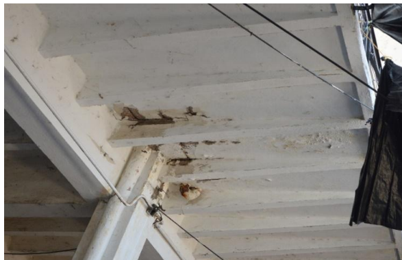
Figura 90. Corrosión en los aceros estructurales
