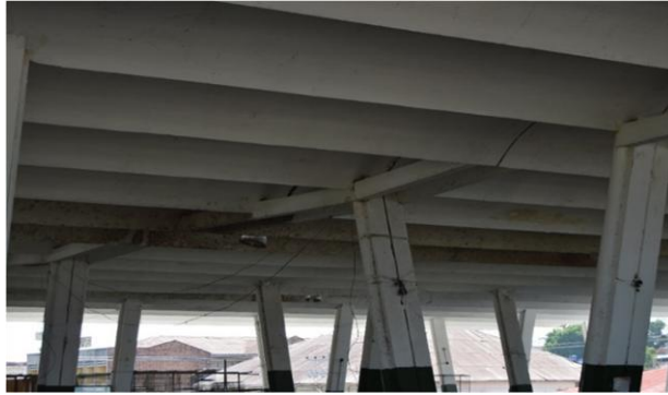
Figura 89. Lesiones mecánicas en cubierta
